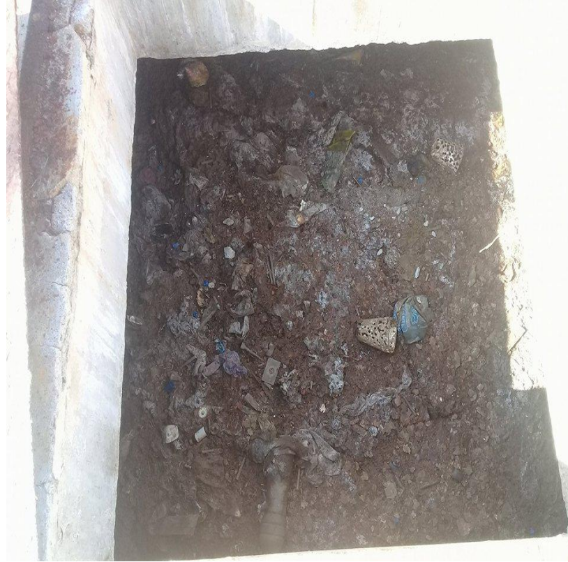
Imagen 3. Sedimentador con acumulación de lodos de más de un año, presencia de malos olores y vectores perjudiciales a la salud.
