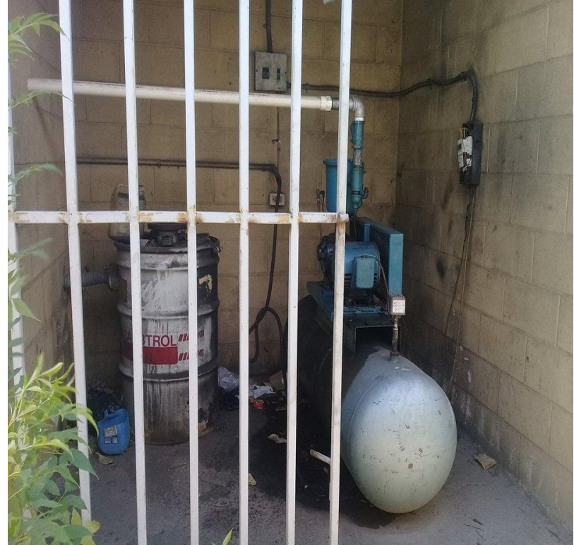
Imagen 4. Caseta de bombeo, sin protección que restrinja el paso a cualquier persona.
