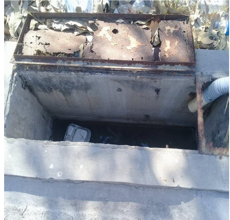
Imagen 2. Tapa de la entrada de caudal deteriorada, oxidada sin poder cumplir función
