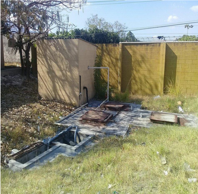
Imagen 1. Estructura completa de planta de tratamiento de la Unidad de Emergencia.
