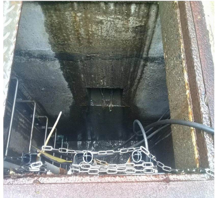
Imagen 6 . Rejillas con sistema de aireación, efluente que luego pasa al tanque de regulación de flujo.
