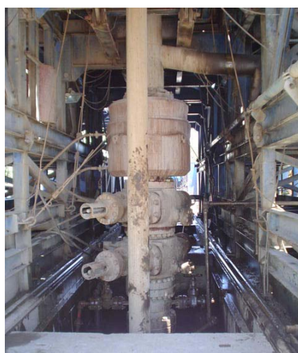
Figura 25. Sistema de preventores en pozo TR-18, Berlín
