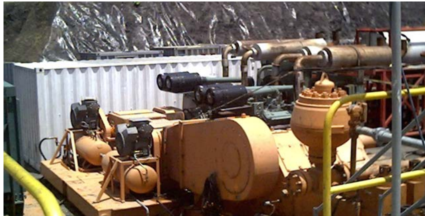
Figura 27. Bombas de alta presión.
