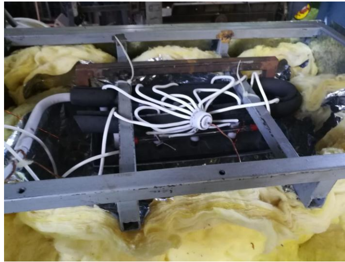
Figura 33. Manifold creado para solventar problema de estancamiento. Fuente: imagen propia.
