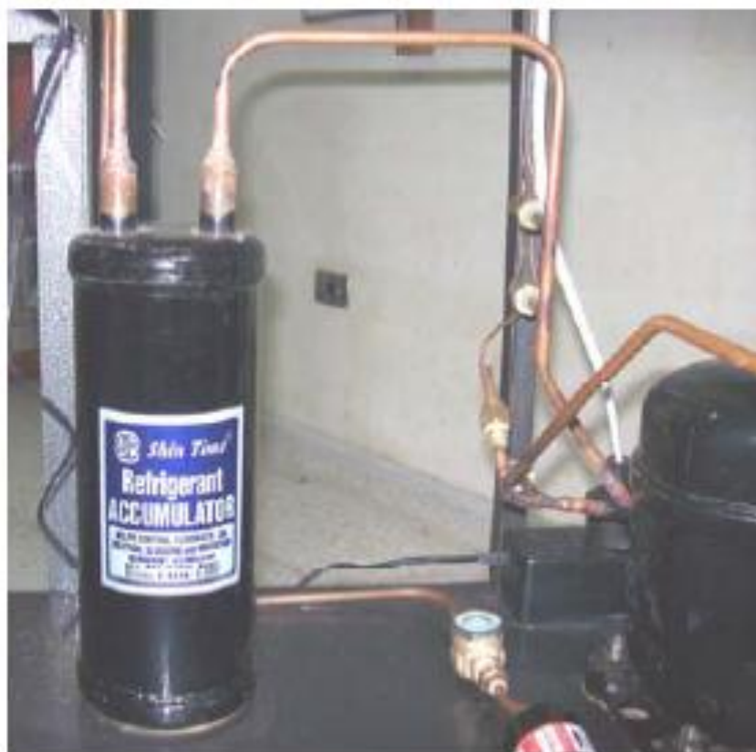
Figura 20. Botella de aspiración de ejemplo instalada [9].
