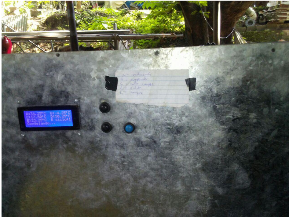
Figura 39. Montaje provisional de pantalla y botones de control del sistema. Fuente: imagen propia.
