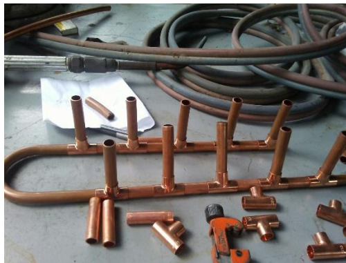
Figura 30. Evaporador construido Fuente: imagen propia.
