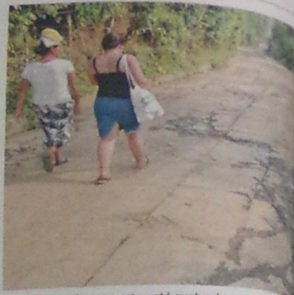
La cubierta de concreto está quebrada y muchos vendedores temen que se deteriore más sin que se defina qué entidad será responsable de repararla.
