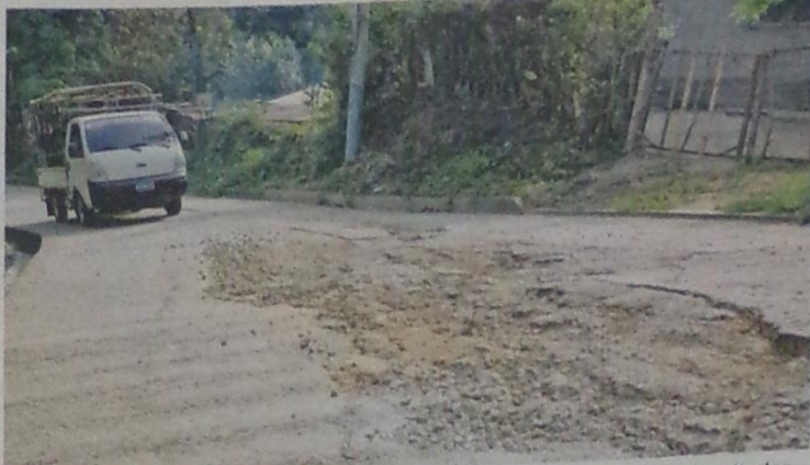
Los conductores sufren al esquivar los baches. Pero hay tramos en que es imposible evitarlos
