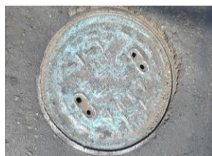
FOTOGRAFÍA 18: Vista de pozo de Aguas . Fuente: Galería de los autores (2018).
