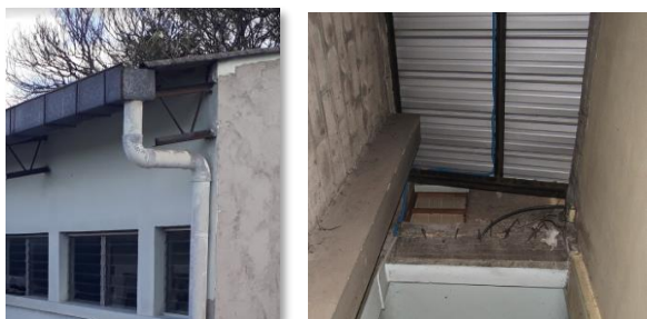
FOTOGRAFÍA 36: Vista de vigas Macomber y polines tipo C. Fuente: galería autores.
