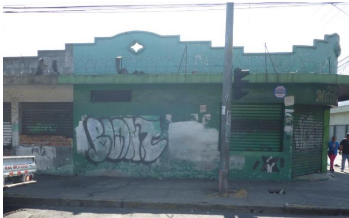
FOTOGRAFÍA 25: Vista de fachada en mal estado. Ubicada sobre 10º Av. Norte. Fuente: Galería de los autores (2018).
