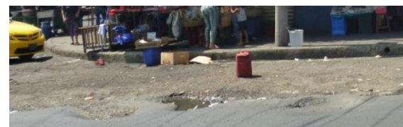
FOTOGRAFÍA 20: Vista de tramo de cuneta y calle en mal estado. Fuente: Galería de los autores (2018).
