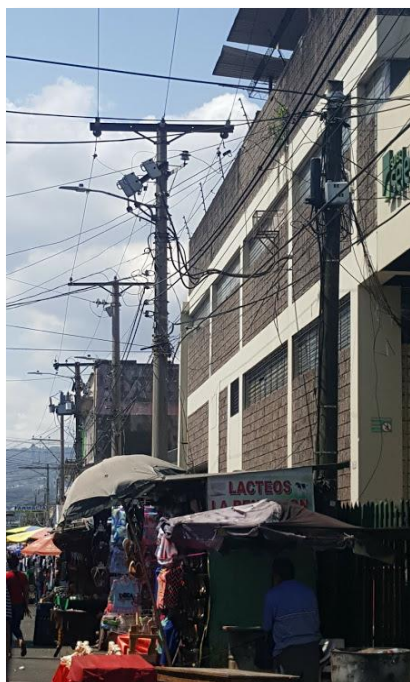
FOTOGRAFÍA 21: Vista de tendido eléctrico. Fuente: Galería de los autores (2018).
