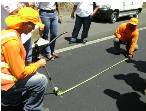
Fig. 3.22a Medición de las longitudes de las grietas o fisuras
