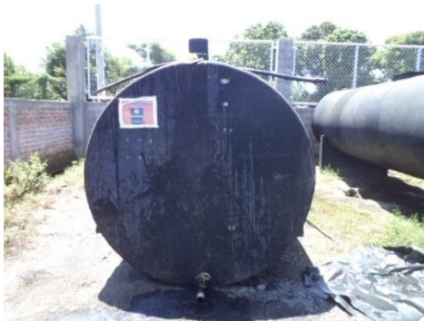
Fig. 3.24c a. Tanques de almacenamiento de emulsión
