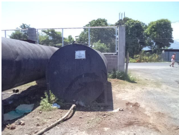
Fig. 3.12c Tanque de almacenamiento de agua potable
