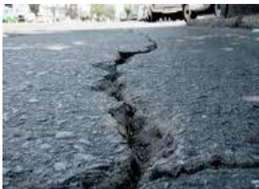
Fig. 2.15 Grieta longitudinal en Av. Ilopango
