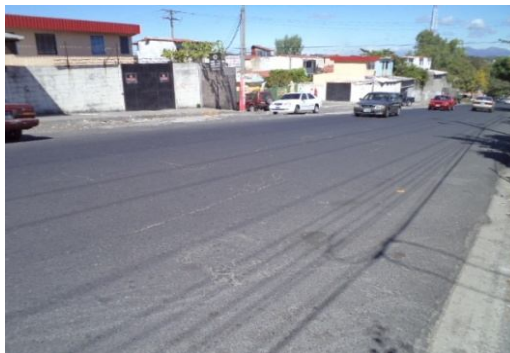
Fig. 2.13 Fisura longitudinal en Av. Ilopango
