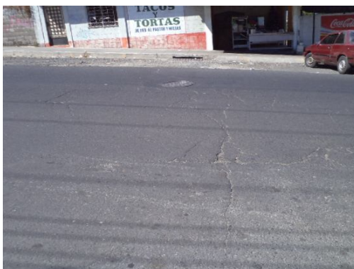
Fig. 2.12 Fisura transversal en Calle Olomega
