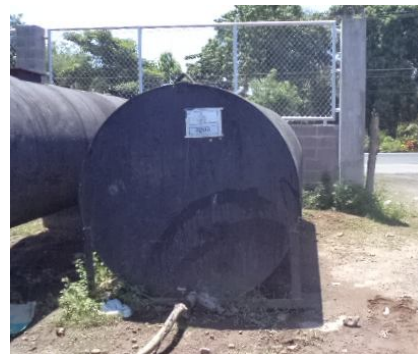
Fig. 3.24c b. Tanques de almacenamiento de agua
