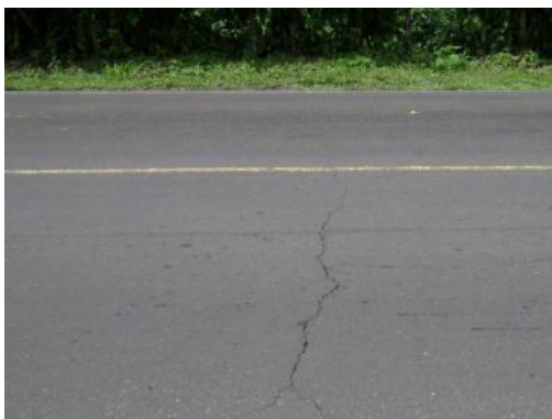
Fig. 3.17a Identificación de grietas y fisuras a reparar
