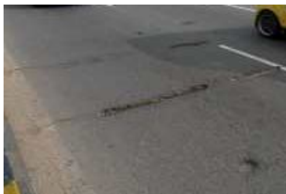
Fig. 2.14 Grieta transversal en Boulevard del ejército
