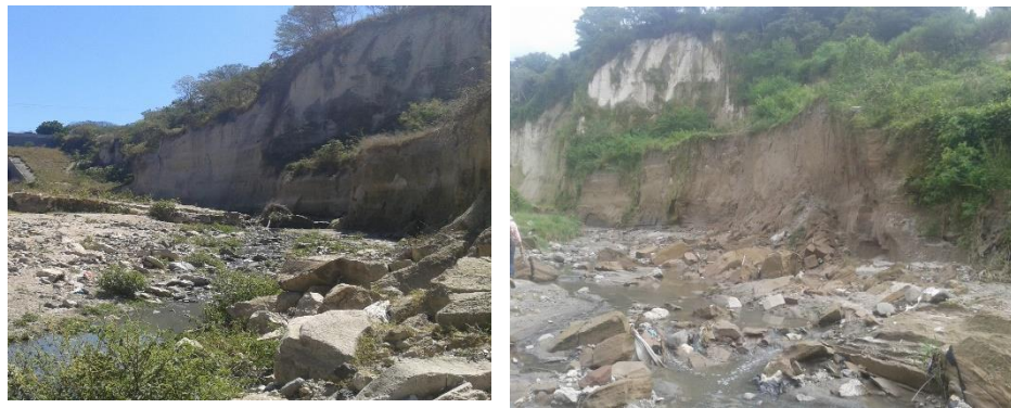
Figura No. 5.2.5 Imágenes del PUNTO No.10 TALUD ZONA FRANCA III, figura del costado izquierdo tomada el 3/2/17 y la figura del costado derecho tomada el 2/10/17 Fuente: EL AUTOR
