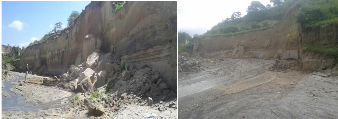
Figura No. 5.2.29 Fotografías del PUNTO No.3 TALUD AEROPUERTO II; en el costado izquierdo se puede observar para el día 24/4/17 y en el costado derecho afectado por los procesos erosivos el día 2/10/2017. Fuente: EL AUTOR
