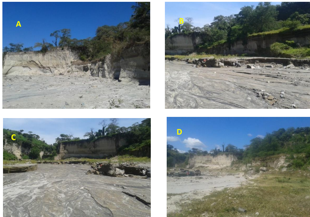
Figura No. 5.2.46 Cambios en el nivel del río del PUNTO No. 2 TALUD AEROPUERTO I; La Figura A es de la fecha 20/3/17, la Figura B y C es de la fecha 28/07/17 y la Figura D es de la fecha 16/11/17. Fuente: EL AUTOR
