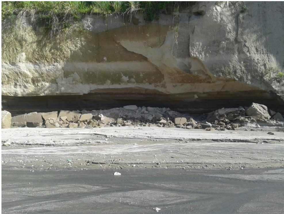
Figura No. 2.3.10 Presencia de erosión en la base del talud, Aeropuerto de Ilopango Fuente: DEL AUTOR, Fotografía tomada el 3/7/2017
