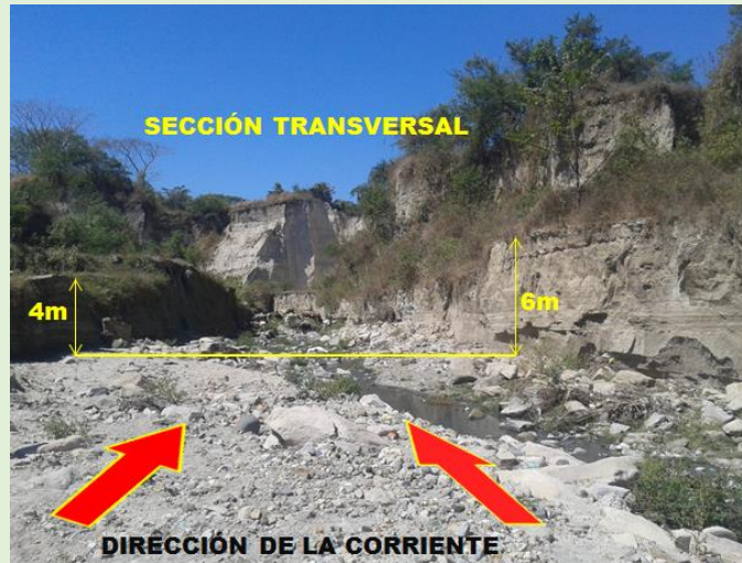
Figura No. 4.4.20 Talud ubicado en Zona Franca de Ilopango Fuente: EL AUTOR, fotografía tomada 3/02/2017
