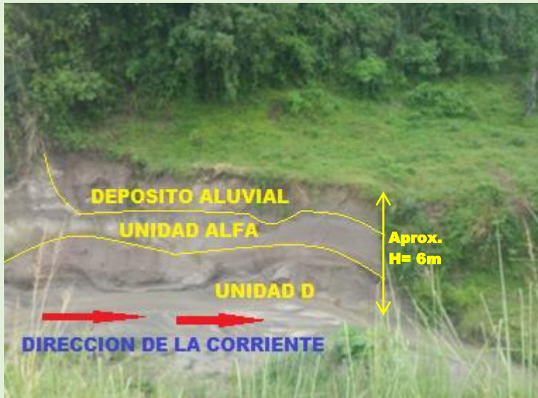
Figura No. 4.4.3 Talud ubicado frente a cementerio Los Cipreses Fuente: EL AUTOR, apoyado en Bautista et al, 2016. "Determinación de la tasa de deterioro en taludes constituidos por materiales piroclásticos en el Área Metropolitana de San Salvador (AMSS)". Tesis, Universidad de El Salvador, 2016
