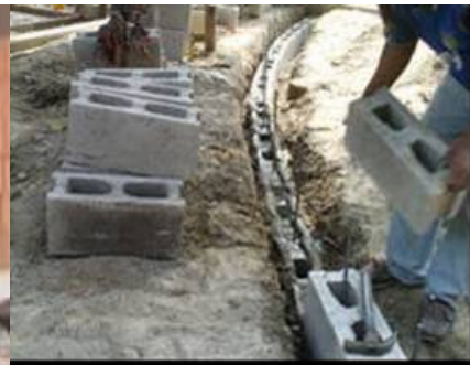
Fig. F. Agarre de Bloques deficiente.
