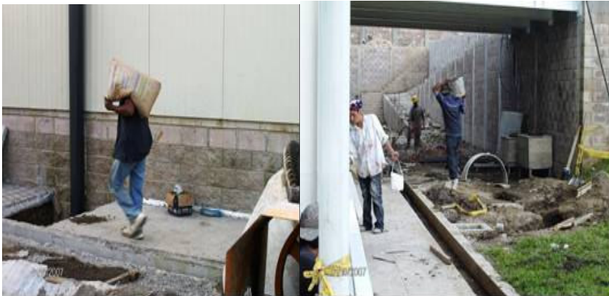
Fig. A Transporte de bolsas de cemento hasta de la obra, obra, con un mal manejo de la carga.
