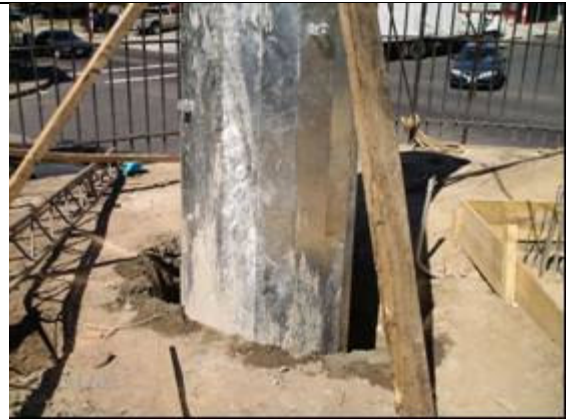
Fotografía 142-Apuntalamiento de base de torre Golpes contra objetos
