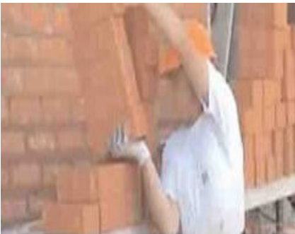
Fig. E. Agarre y transporte de ladrillos deficiente.
