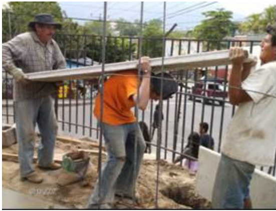
Fotografía 127- Descarga de prefabricados Posturas forzadas levantamientos forzados / espalda y cuello inclinados desequilibrio en la carga
