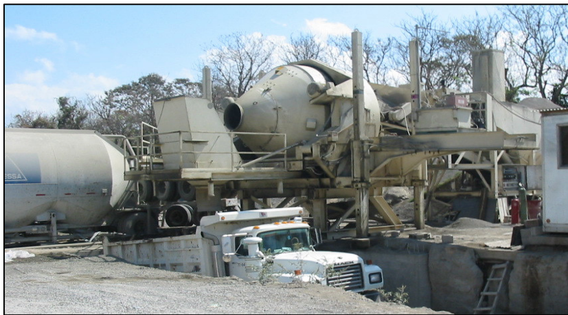
Ilustración II- 25-Planta portátil de concreto.
