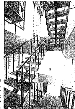
GRADAS DEL MINISTERIO DE GOBERNACIÓN. • Actualmente solo hay un ascensor funcionando de los dos elevadores que dispone el edificio.
