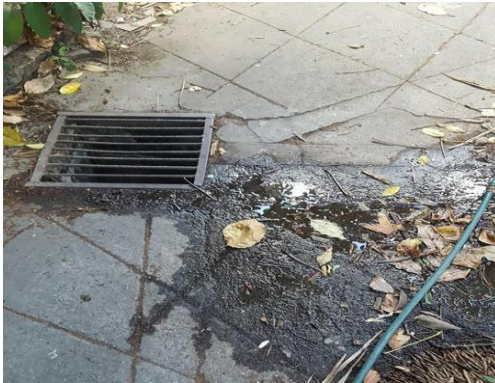
Resumidero en mal estado costado poniente de la UOT
