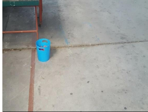
Resumidero en mal estado costado poniente de la UOT
