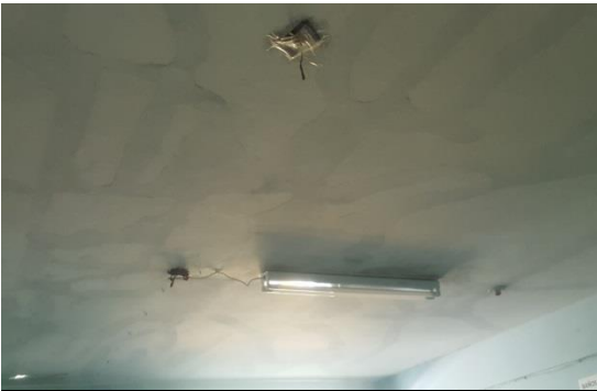
Instalaciones eléctricas en mal estados en el área de lavandería
