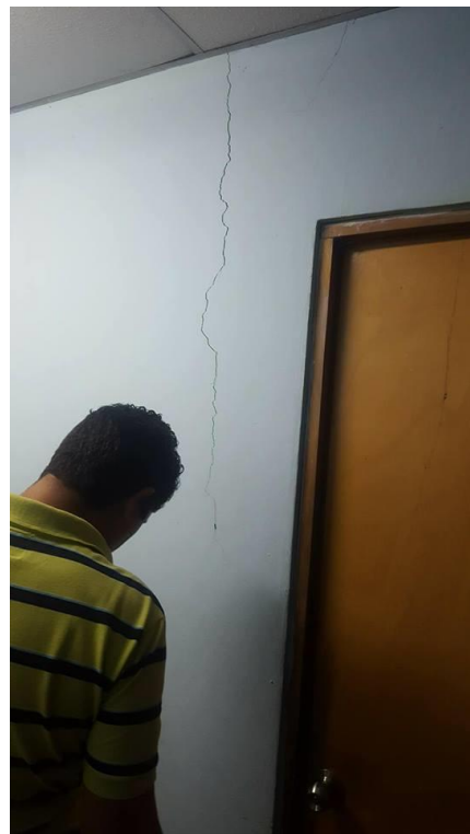
Daños infraestructurales en unidad de lesiones afecciones medulares (ULAM)
