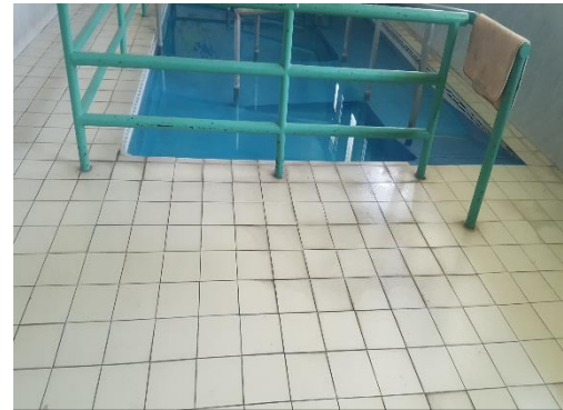
Pisos resbaladizos y falta de señalización de profundidad en unidad de Hidroterapia
