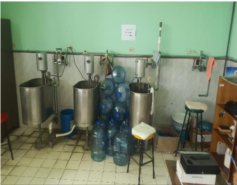
Garrafones de agua colocados en área de máquinas en unidad de Hidroterapia
