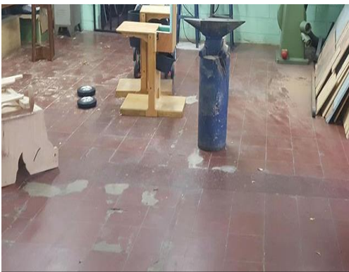
Pisos con abundantes baches en unidad de Ortopedia Técnica-UOT
