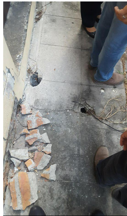
Daños infraestructurales en edificio de asilo
