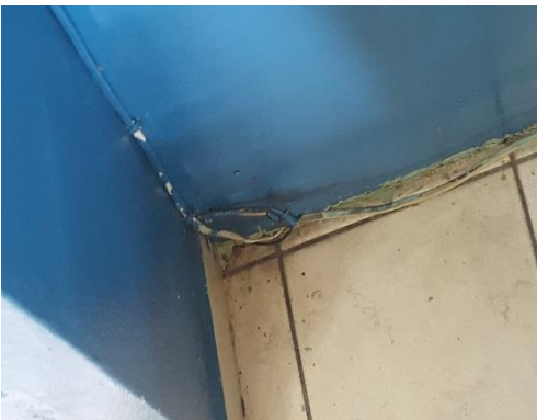
Conexiones eléctricas expuestas en unidad de psicología
