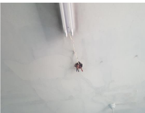
Conexiones eléctricas expuestas en unidad de lesiones y afecciones medulares-ULAM
