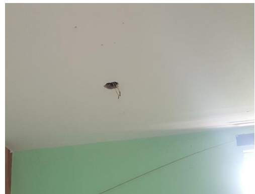
Conexiones eléctricas expuestas, en unidad de traumatología
