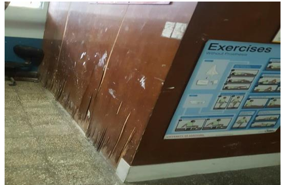
Áreas de atención deterioradas en ULAM
