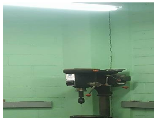
Paredes con prolongadas grietas en unidad de Ortopedia Técnica-UOT
