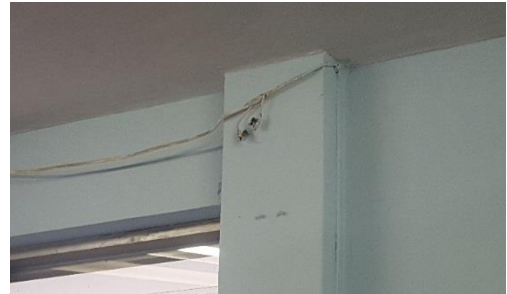
Conexiones eléctricas expuestas en unidad de Terapia ocupacional.
