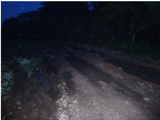
Inundación camino al punto 4 en sector La Barra.
