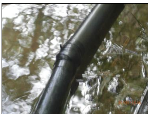
Figura 14. Enmendaduras artesanales en tubos conductores del agua.
