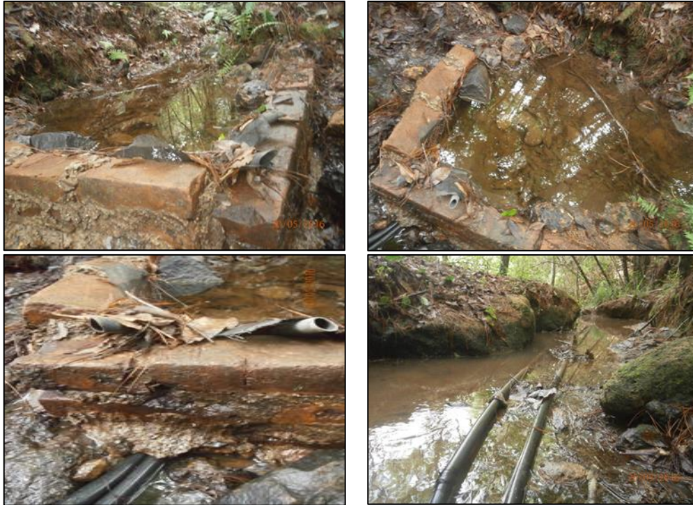
Figura 11. Pileta para provisión de agua en río donde se conectan tubos que la trasladan hacia las parcelas.
