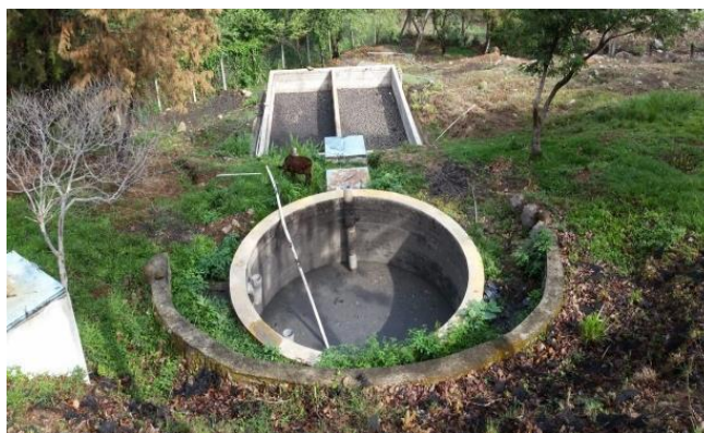
Figura 6. Digestor de lodos.
