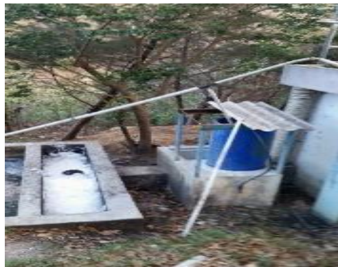
Figura 5. Tanque de Cloración.
