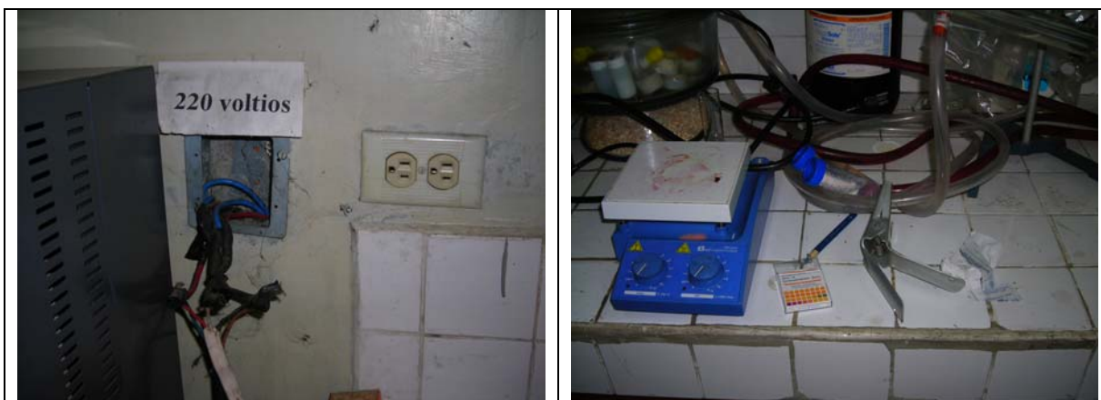
Figura 3.62: Imágenes de aspectos de seguridad y gestión eléctrica del área de prácticas de laboratorio del CIAN
