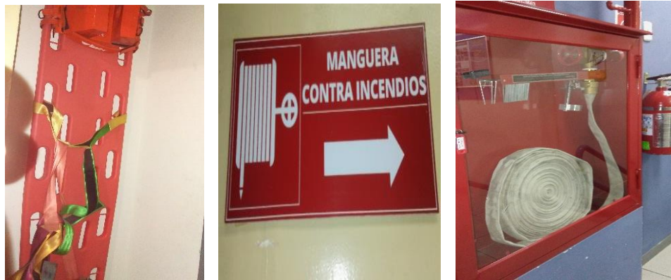
Figura N° 23. Camilla de primeros auxilios y manguera contra incendios con su respectiva señalización observados.
