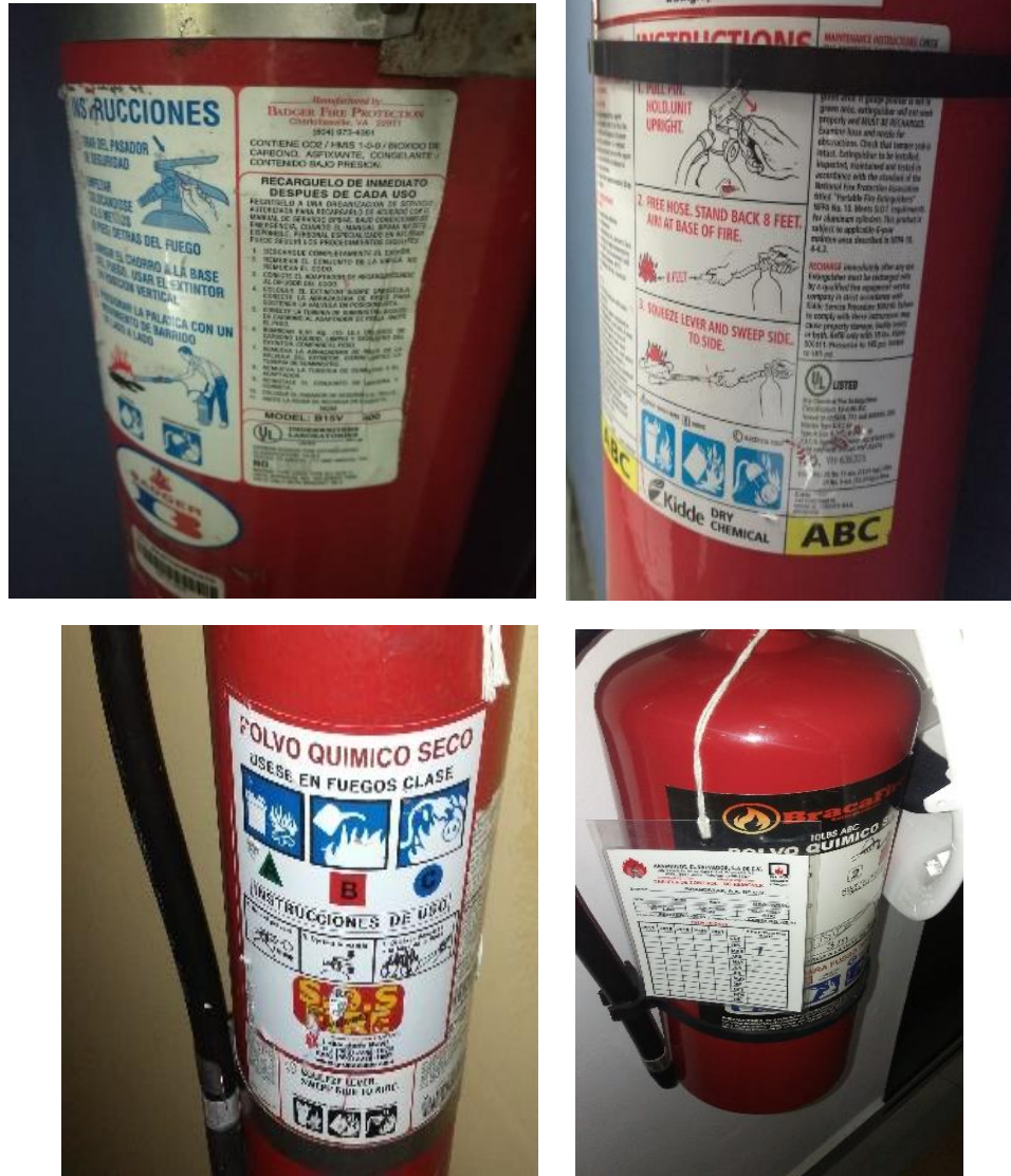
Figura N o 21. Fotografía de algunos extintores vistos en las instalaciones de las empresas con sus respectivas indicaciones de uso y viñeta de revisión de extintores.
