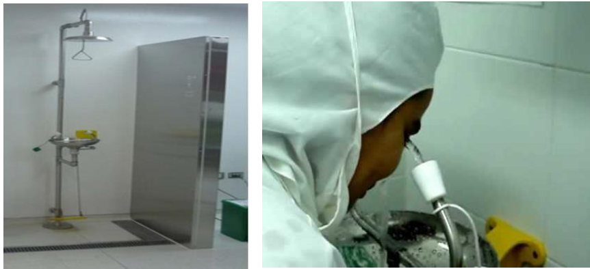
Figura N° 8. Duchas de seguridad y lavado de ojos.
