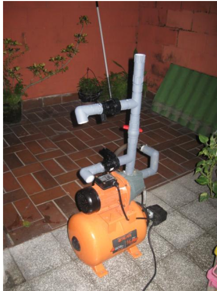
Figura 2.16 Bomba conectada a sección de válvulas.
