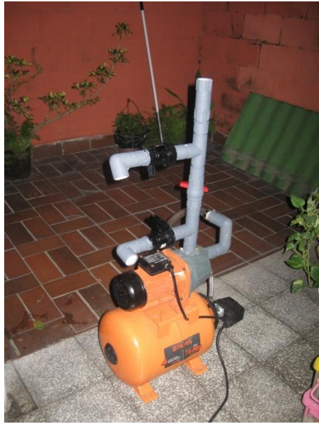
Figura 2.9 Conexión de bomba, uniones y válvulas.
