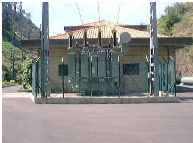
Imagen 3: Transformador de Potencia
