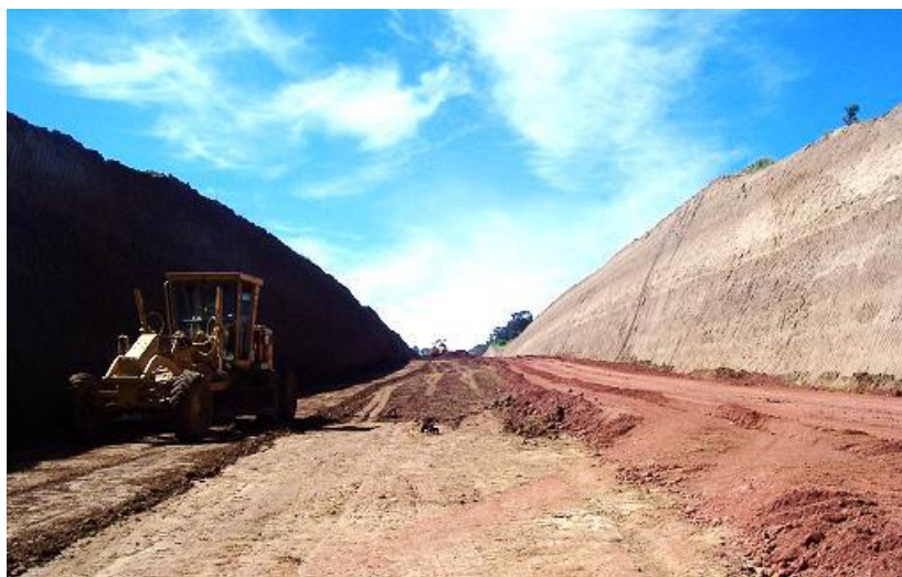
Imagen 50: Vista de un corte, donde se pueden observar los taludes y la superficie subrasante.
