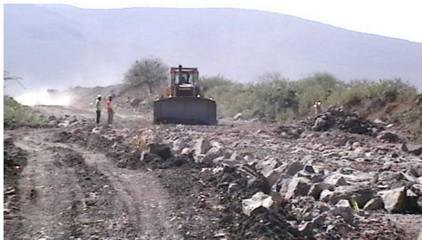
Imagen 37: Formación de terraplén con material no compactable.
