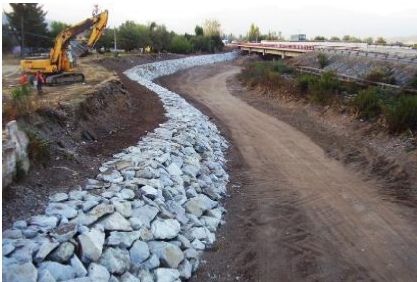
Imagen 65: Zampeado para protección de taludes.
