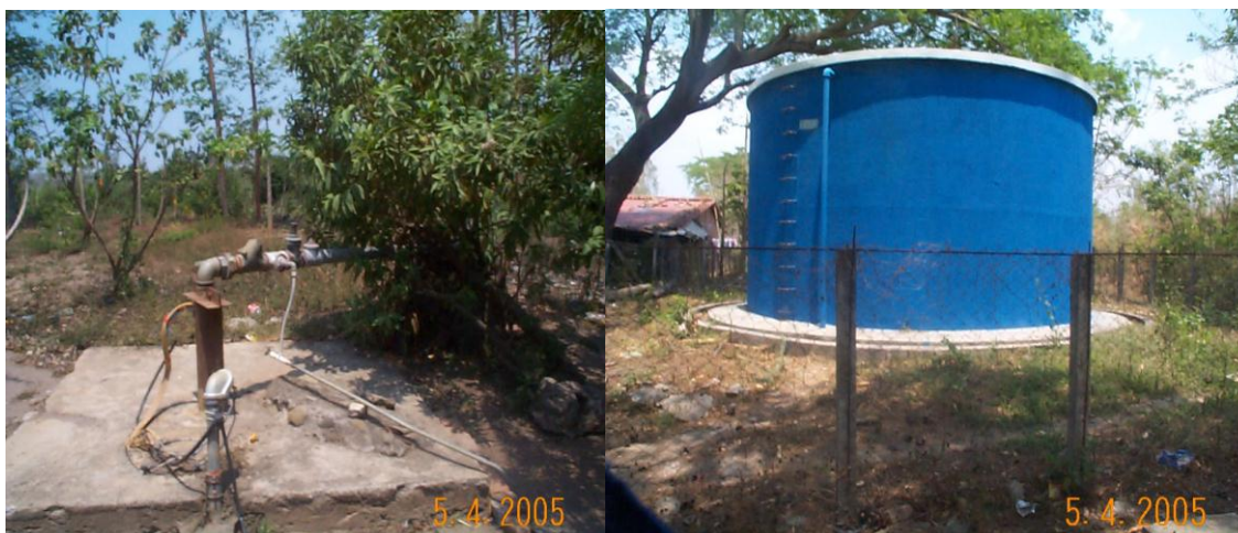
FIGURA 5.2 BOMBA DE EXTRACCIÓN DE AGUA COMUNIDAD MELARA (Fuente: Propia)
