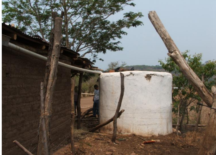
FIGURA 4.1 TANQUE DE CAPTACION DE AGUA LLUVIA COMUNIDAD SAN LUIS EL COYOLAR. (Fuente: Propia)
