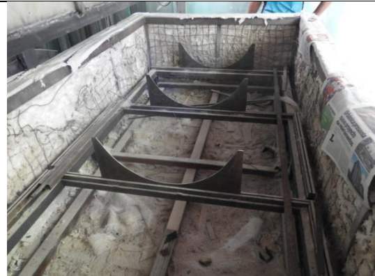
Ilustración 45. Ilustración de moldes de hierro instalados en el horno usado en termoformado para el manual.
