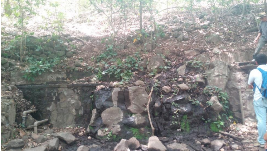
Fotografía 3. Levantamiento de inventario de puntos de agua. Sistemas de captación de agua en manantiales ubicados en el cantón El Zapote, municipio de Suchitoto.
