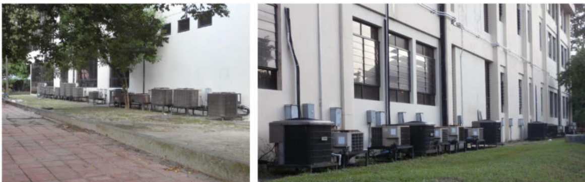
Ilustración 51 Equipos de aire acondicionado en el Edificio Administrativo y el Edificio de Industrial
