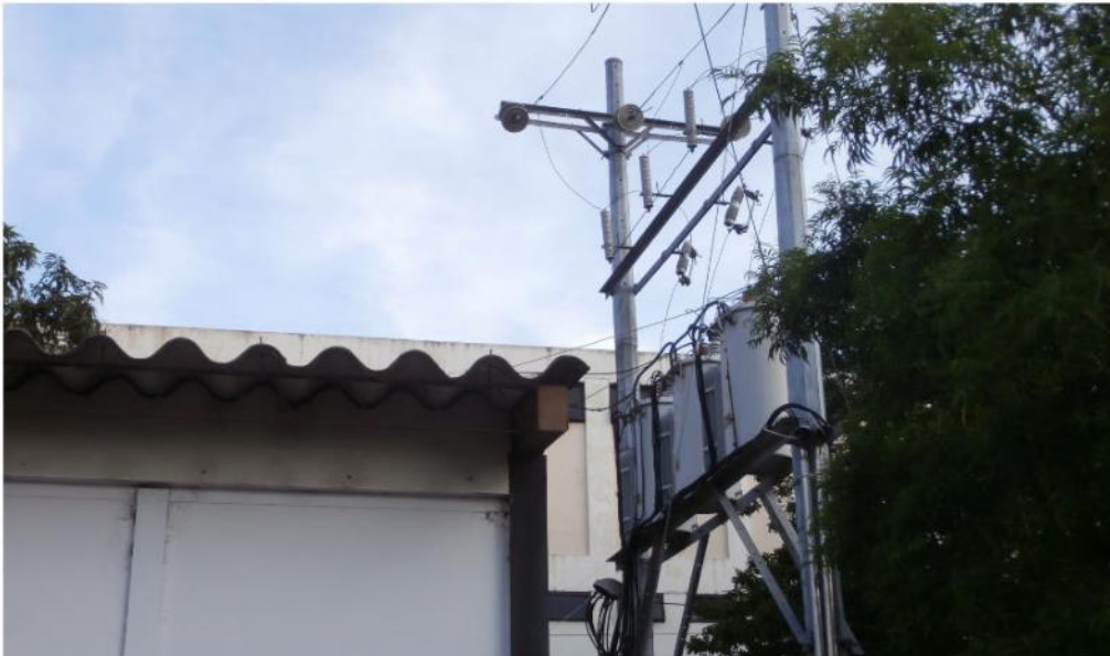
Ilustración 28 Transformadores en Edificio Administrativo (Toldo azul)
