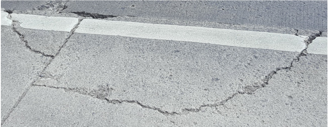
Figura 4.13 Sección de grietas de esquina. Interconexión tramo I. San Salvador.
