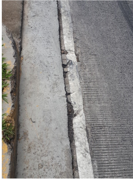
Figura 4.4 Sección de erosión por bombeo. Boulevard Orden de Malta. San Salvador
