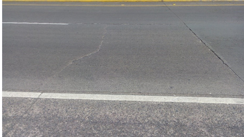
Figura 4.3 Sección de fisura transversal. Interconexión tramo I. San Salvador.
