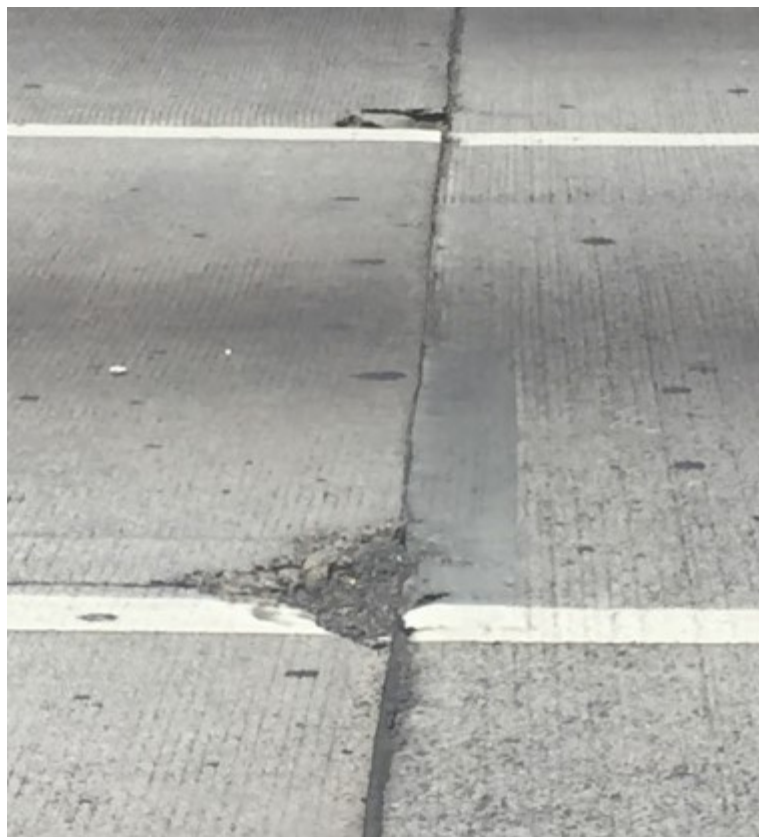
Figura 2.24 Despostillamiento. (Boulevard Monseñor Romero tramo I).
