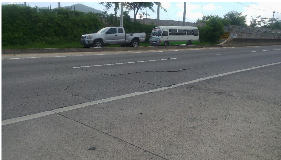
Figura 2.17 Hundimiento en pavimento de concreto Interconexión tramo II.
