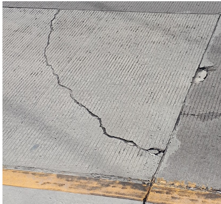
Figura 4.9 Sección de Grieta de esquina. Interconexión tramo II. San Salvador.
