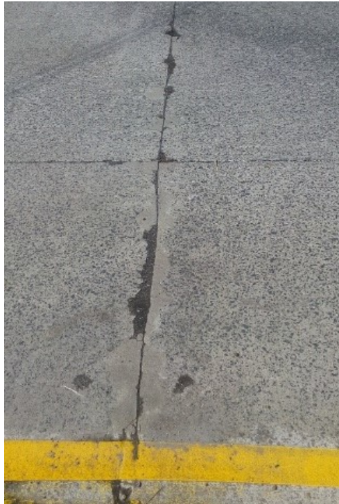
Figura 4.6 Sección de despostillamiento. Boulevard Orden de Malta. San Salvador.
