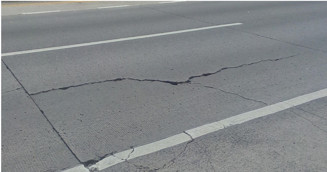
Figura 4.11 Grieta longitudinal. Interconexión tramo I. San Salvador.
