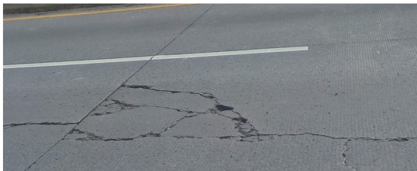
Figura 2.13 Fisuras en Bloque Interconexión tramo II.
