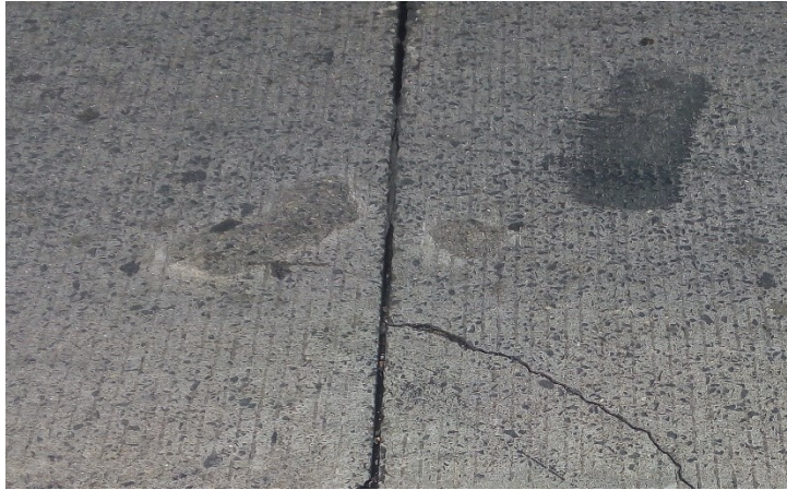
Figura 2.18 Descascaramiento y Fisuras capilares Boulevard Orden de Malta.
