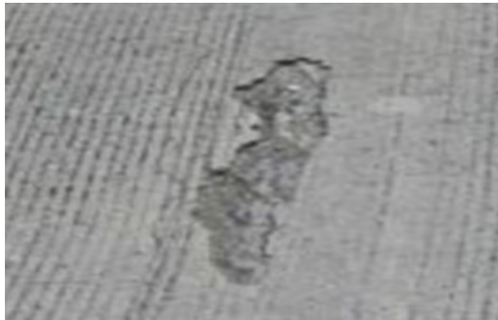
Figura 2.19 Descascaramiento y Fisuras capilares Boulevard Orden de Malta.
