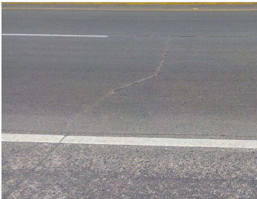
Figura 2.9 Fisura transversal Tramo II Interconexión
