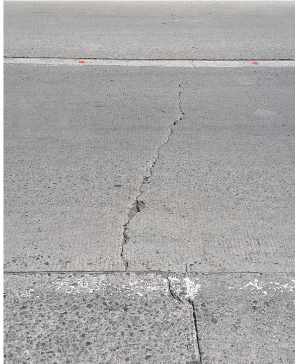
Figura 4.10 Grietas transversales. Interconexión tramo II. San Salvador.
