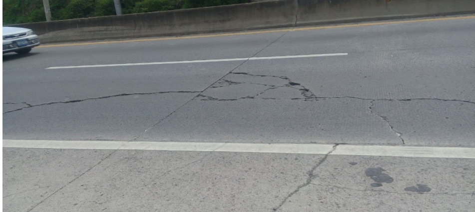
Figura 4.7 Sección de fisuras en bloque. Boulevard Orden de Malta. San Salvador.
