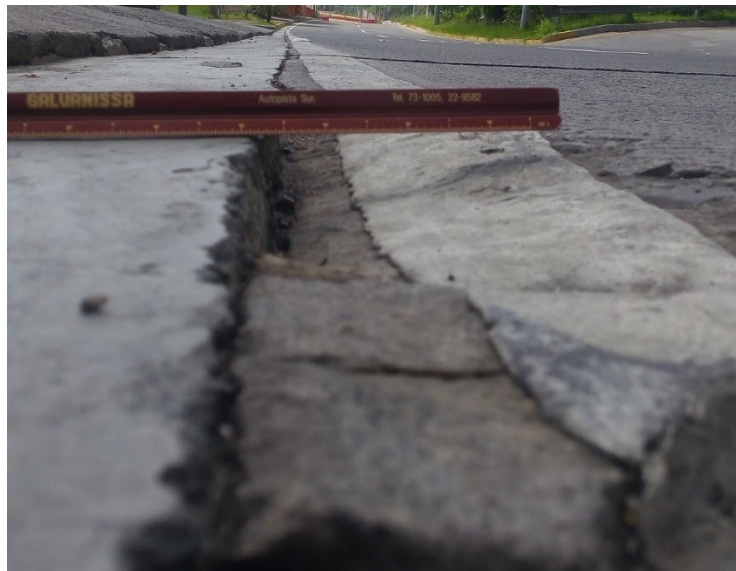
Figura 4.5 Sección de erosión por bombeo. Boulevard Orden de Malta. San Salvador.
