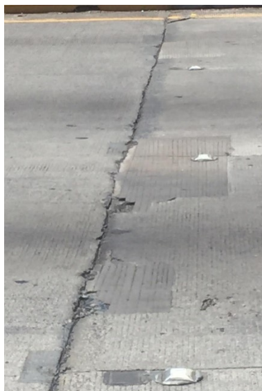
Figura 2.23 Deficiencia en el sello de juntas entre losas adyacentes. (Boulevard Orden de Malta).
