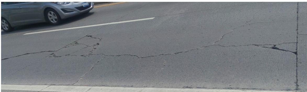
Figura 2.10 Fisuras longitudinales Interconexión tramo II
