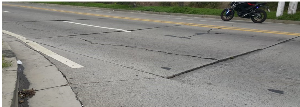
Figura 4.8 Escalonamiento en losa de concreto. 50 Av. Norte, San Salvador.
