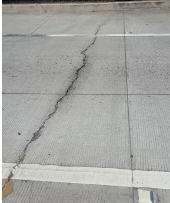
Figura 2.14 Fisuras inducidas Boulevard Monseñor Romero
