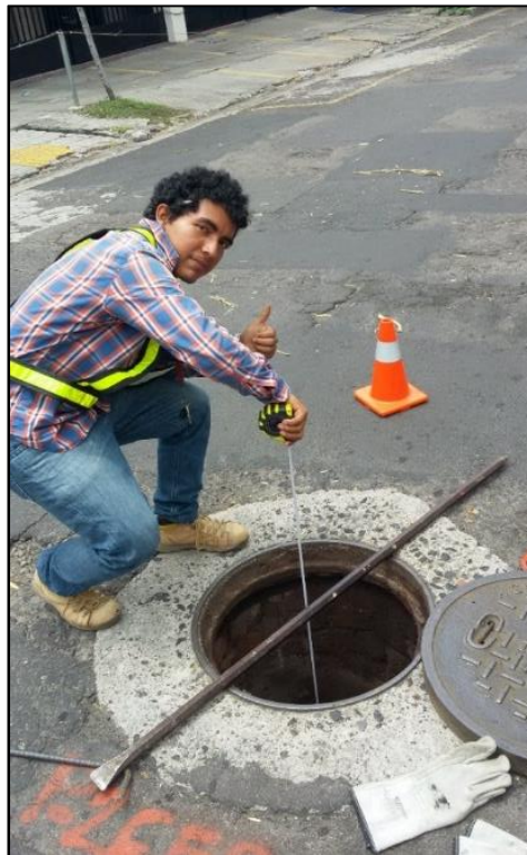
Figura 3.24. Toma de elevación de tuberías desde tapadera del pozo de visita.
