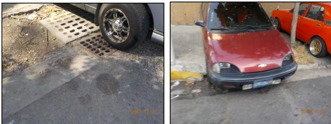
Figura 3.2. Obstrucción de tragantes en la zona de estudio.
