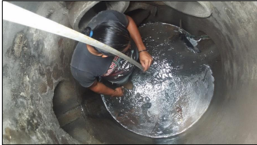
Figura 3.23. Toma de elevación de tuberías desde tapadera del pozo de visita.
