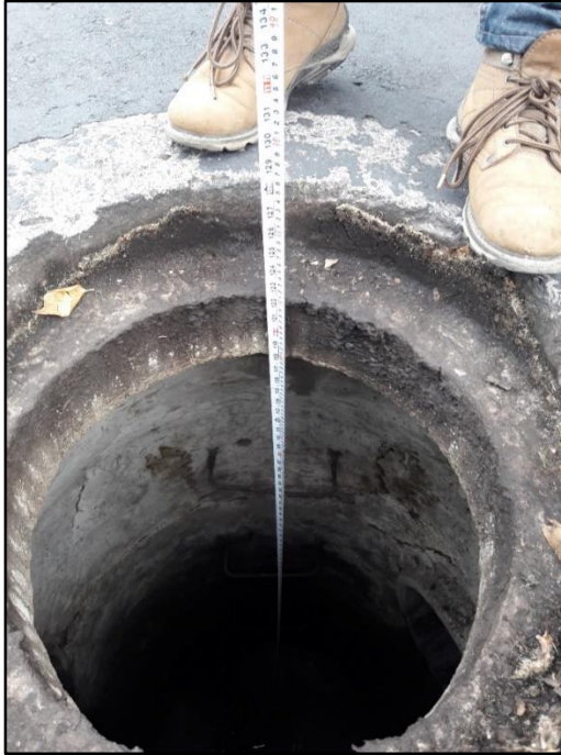
Figura 3.5. Pozos de visita con una profundidad mayor a 3 metros.
