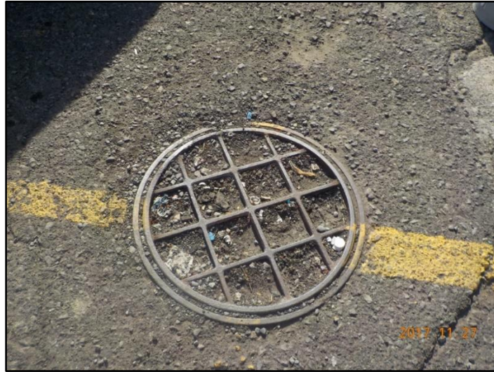
Figura 3.3. Tapaderas de pozos de visita sin haladeras. Fuente: Elaboración Propia.
