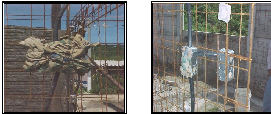
Figura 2.61: Malos Procesos Seguidos para la Colocación de Cajas, Tomas de Corriente y Ducterías. Tomada de Revista ISCYC.
