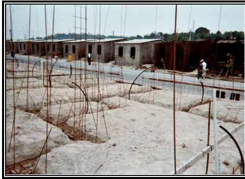
Figura 2.41: Ductos para Instalaciones Eléctricas.
