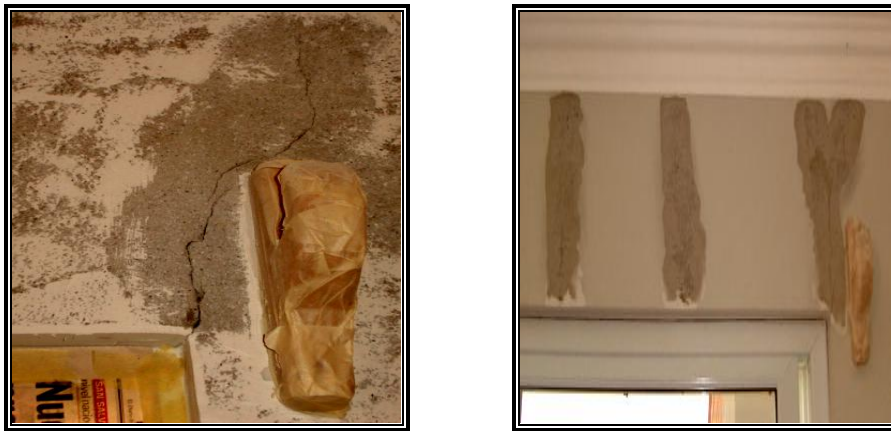
Figura 2.63: Agrietamiento Ocasionado por Planos de Debilidad en Puertas y Ventanas. Tomada de Revista ISCYC.
