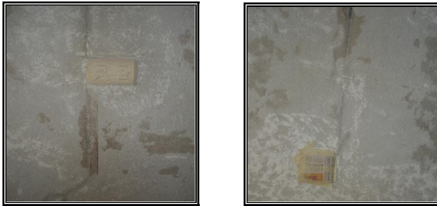
Figura 2.62: Grietas Generadas por Malos Procesos Constructivos. Tomada de Revista ISCYC.
