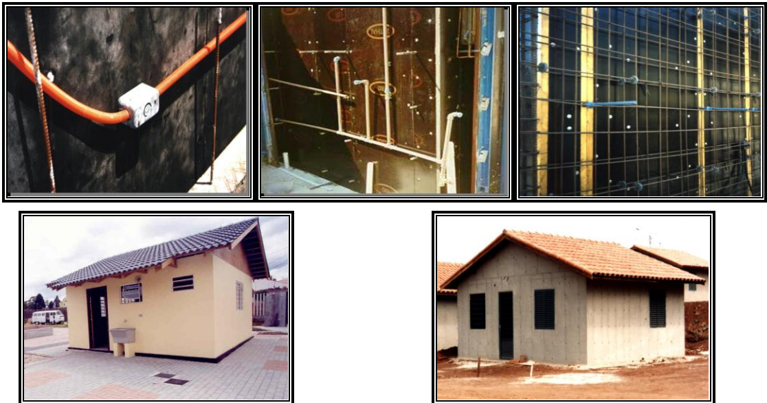
Figura 2.51: Viviendas Construidas de Manera Correcta. Tomada de Revista Iscyc Nº38; Septiembre, 2005.
