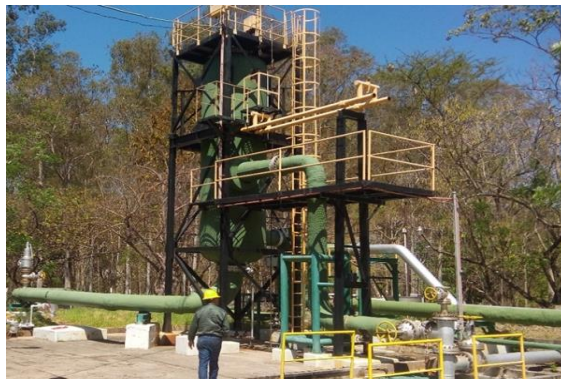
Figura 3 Separador ciclónico instalado en un pozo geotérmico. [Fotografía].
