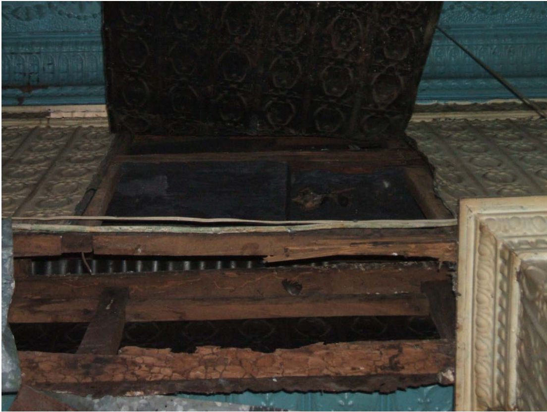
Pieza de estructura de cielo falso dañada, desprendimiento y oxidación.
