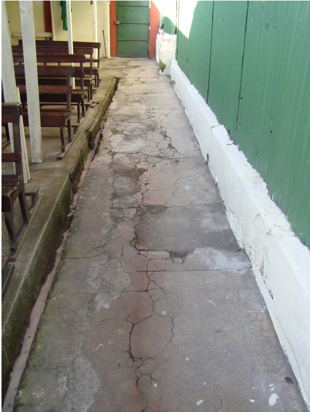
Fachada sur, piso adyacente a fundaciones perimetral con agrietamientos.
