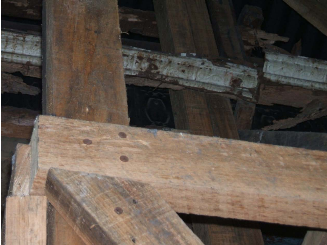
Apuntalamiento de unión viga-columna con daños físicos, madera carcomida.
