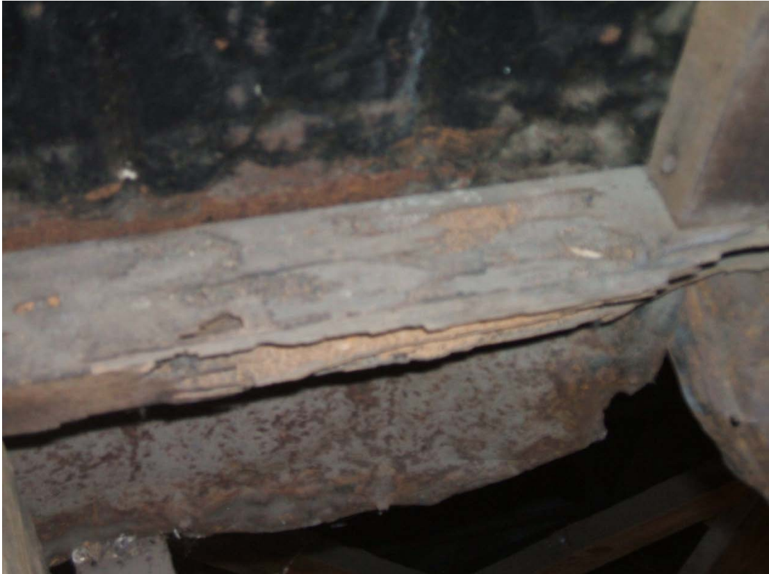
Detalle de viga de estructura de campanario con daños, madera carcomida.
