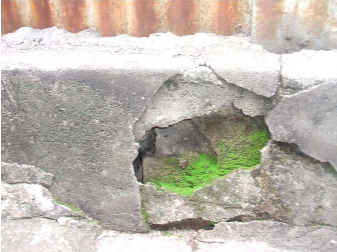
Grieta en fundación perimetral en el murete o sobrefundación.
