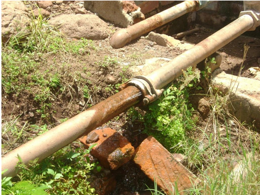
FOTO 4. ESTADO DE TUBERÍAS EN LÍNEA DE ALIMENTACIÓN.
