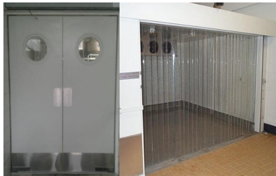
Figura 81. Ejemplo de puertas y protección a las entradas del área de producción
