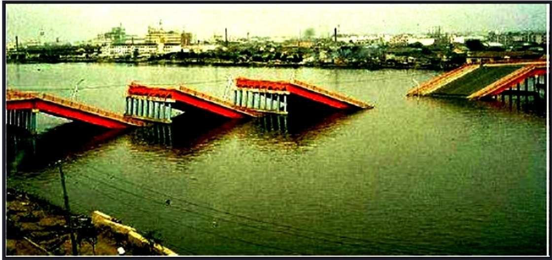
Figura 2.5 Colapso del puente Showa por desplazamiento lateral. Niigata, Japón 1964.
