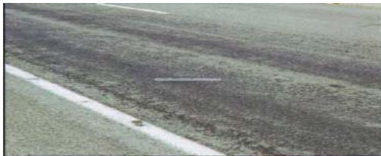
Figura 5.23. Exudación de Asfalto (Fuente: Catálogo de Daños de SIECA)
