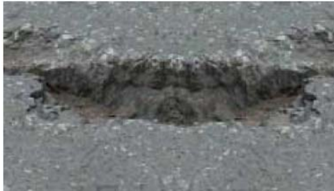
Figura 5.36. Bache con bordes irregulares. (Fuente: Catálogo de Daños de SIECA).
