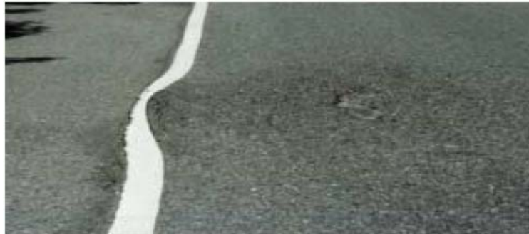
Figura 5.19. Hundimiento. (Fuente: Catálogo de Daños de SIECA)
