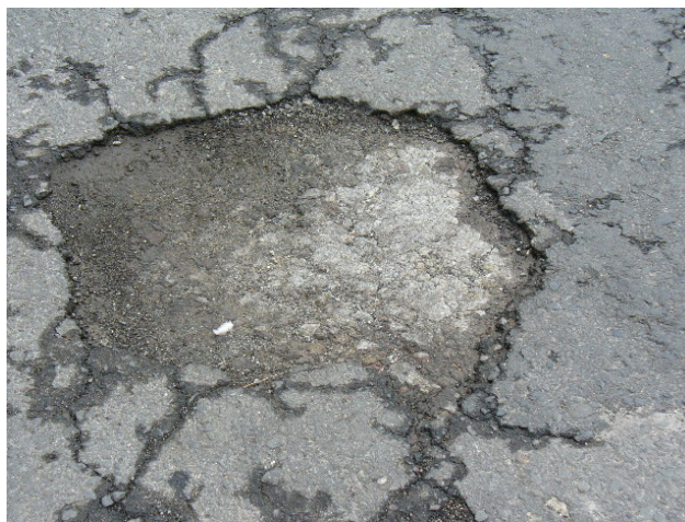
Figura 5.21. Peladura. (Tomada en Colonia Guadalcanal, Ciudad Delgado)
