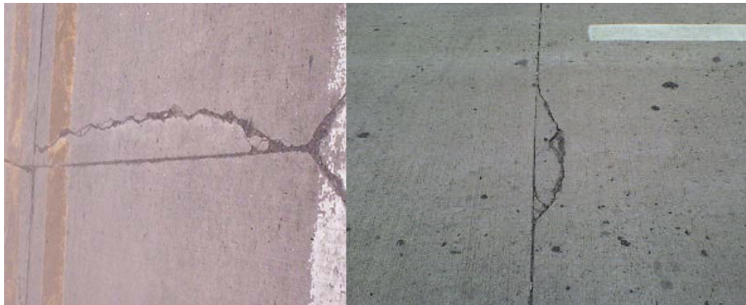
Figuras 5.39 a y b. Fisuras por mal Funcionamiento de Juntas. (Tomadas en Calle al Volcán de San Salvador y 9na. Calle Poniente de Santa Tecla).
