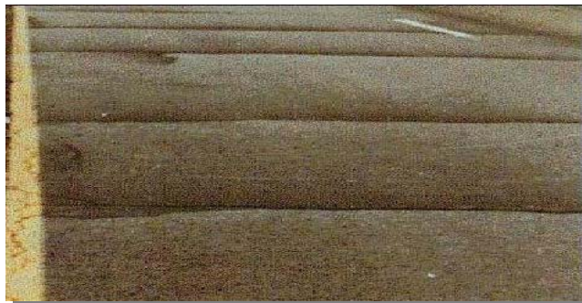
Figura 5.17. Corrugación. (Fuente: Catalogo de Daños SIECA)
