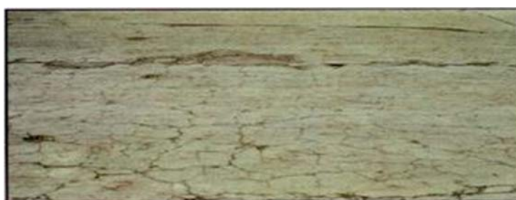
Figura 5.28. Fisuras en Bloque. (Fuente: Catálogo de Daños de SIECA)
