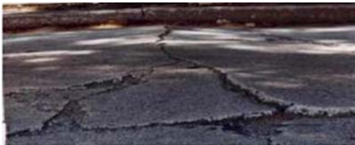
Figura 5.30. Levantamiento de losas, acompañada de rotura. (Fuente: Catálogo de Daños de SIECA)
