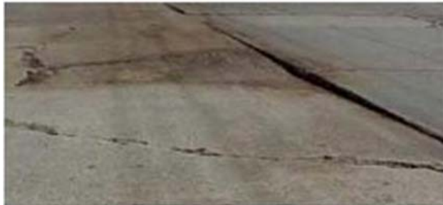
Figura 5.32. Hundimiento acompañado de material sedimentado. (Fuente: Catálogo de Daños de SIECA).
