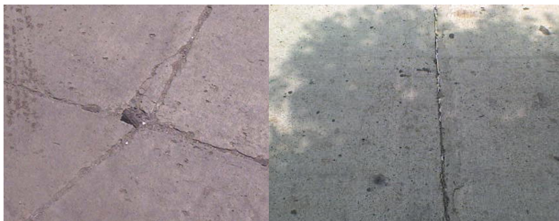
Figuras 5.37 a y b. Deficiencias en Material de Sello. (Tomadas en Calle al Volcán de San Salvador y 9na. Calle Poniente de Santa Tecla).
