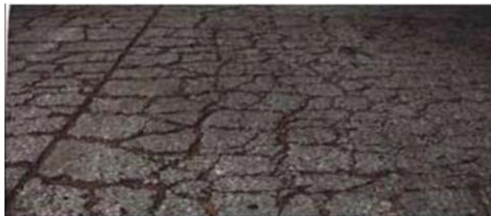
Figura 5.27. Losa Totalmente Subdividida. (Fuente: Catálogo de Daños de SIECA)
