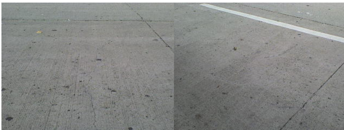
Figuras 5.24 a, b y c. Fisuras Transversales o Diagonales en Losas de Concreto Hidráulico. (Tomadas en Tramo de Carretera San Miguel-La Unión y 9na. Calle Poniente de Santa Tecla)
