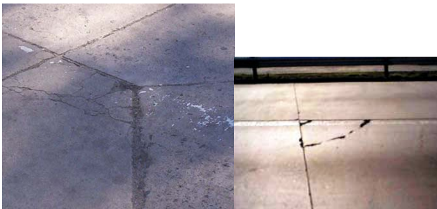
Figuras 5.26 a y b. Fisura de Esquina (Tomadas en Calle al Volcán, de San Salvador)
