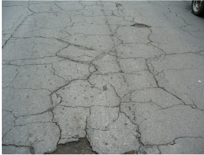
Figura 5.11. Fisura en Bloque. (Tomada en Colonia Guadalcanal, Ciudad Delgado)
