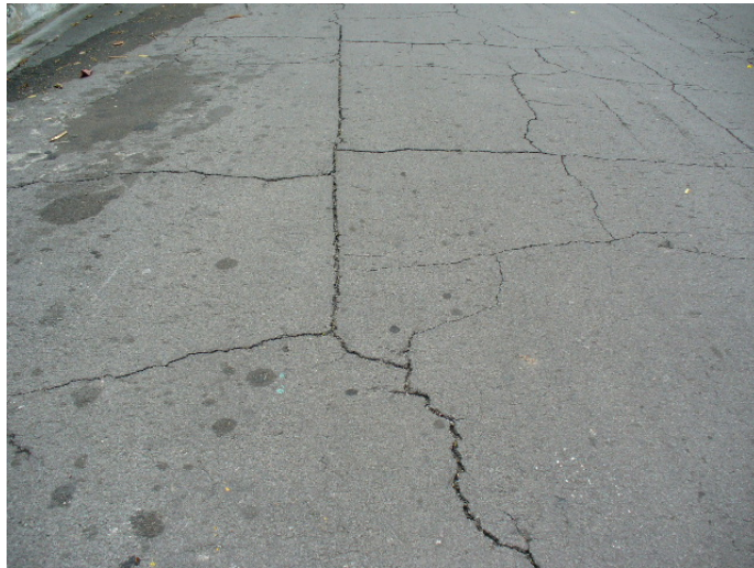
Figura 5.14. Fisura Longitudinal (Tomada en Colonia Guadalcanal, Ciudad Delgado)
