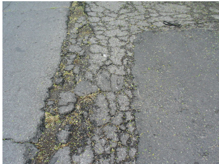
Figura 5.10. Fisura Piel de Cocodrilo (Tomada en Colonia Guadalcanal, Ciudad Delgado)
