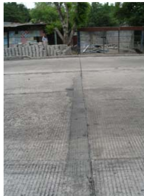
Figura 5.40. Parchados y Reparaciones para Servicios Públicos. (Tomada en Tramo de Carretera San Miguel-La Unión).
