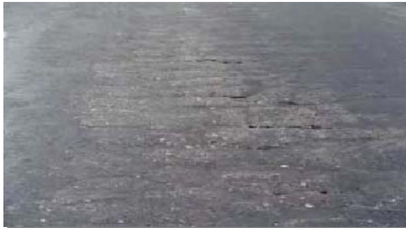
Figura 5.12. Fisura en Arco. (Tomada de Catálogo de Daños, SIECA)
