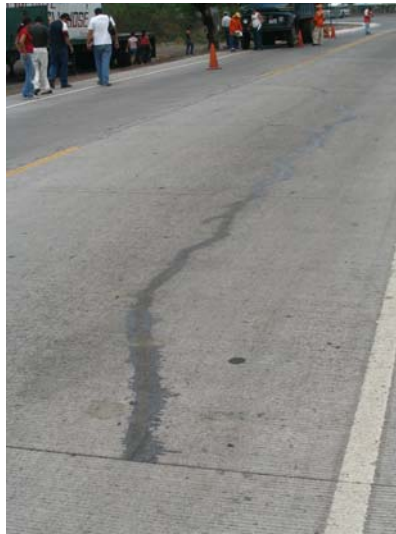
Figuras 5.25 a, b y c. Fisuras Longitudinales en Losas de Concreto Hidráulico (Tomadas en Tramo de Carretera San Miguel-La Unión).
