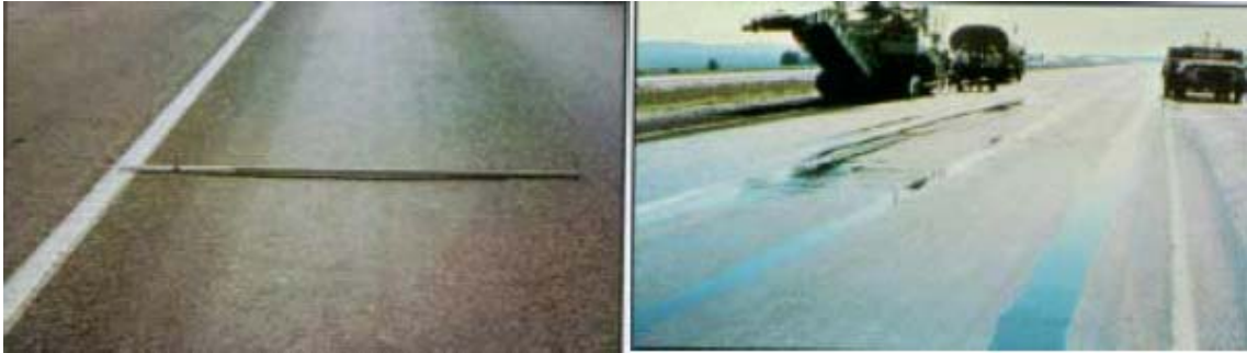
Figura 5.15. Ahuellamiento (Fuente: Catálogo de Daños de SIECA).
