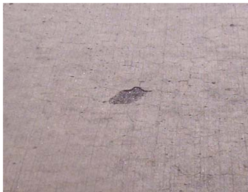
Figura 5.35. Peladura formando cavidades. (Tomada en Calle al Volcán de San Salvador).
