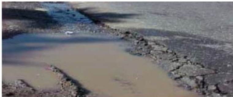
Figura 5.22. Desintegración de Bordes (Fuente: Catálogo de Daños de SIECA)
