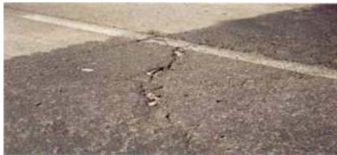
Figura 5.29. Fisura Inducida. (Fuente: Catálogo de Daños de SIECA)
