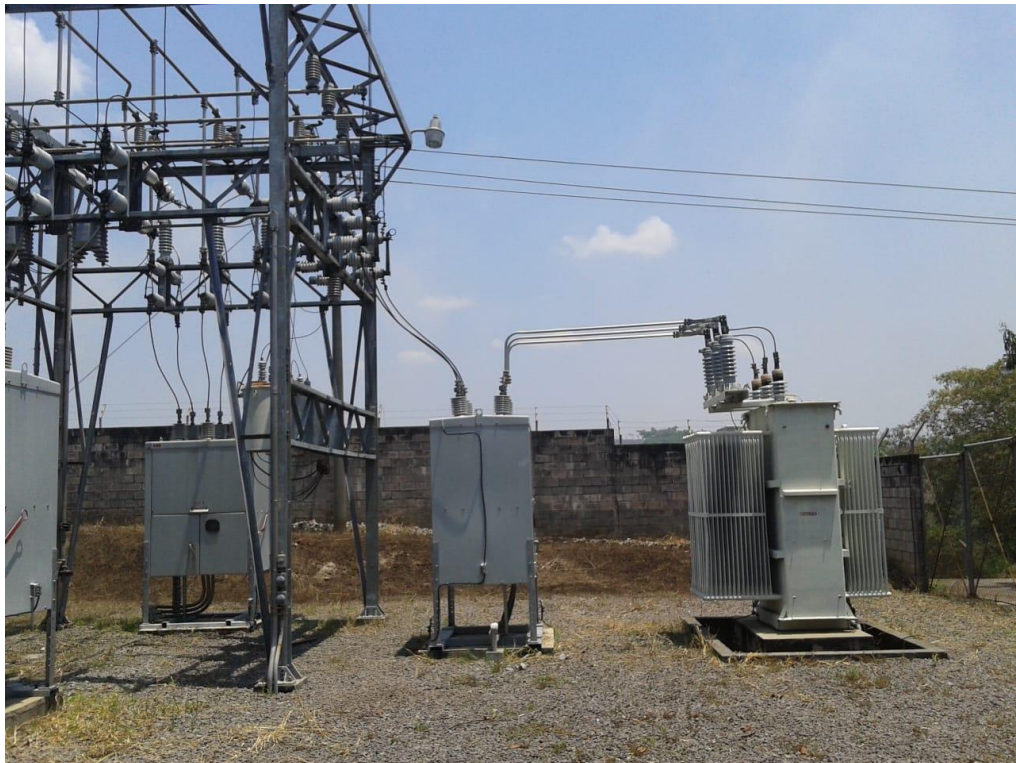
Subestación de bombeo OPICO
