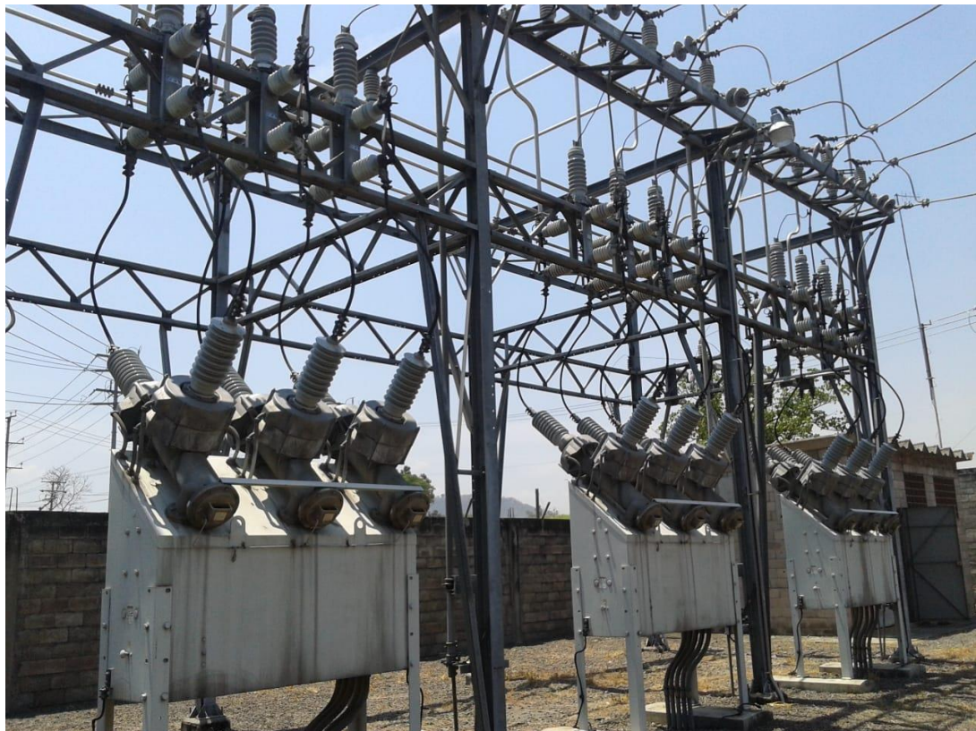
Subestación CEL-ANDA (switcheo)
