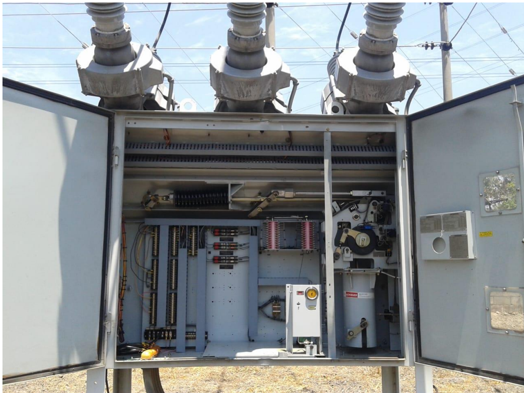
Mecanismo de accionamiento de Interruptores de potencia SF6 ABB
