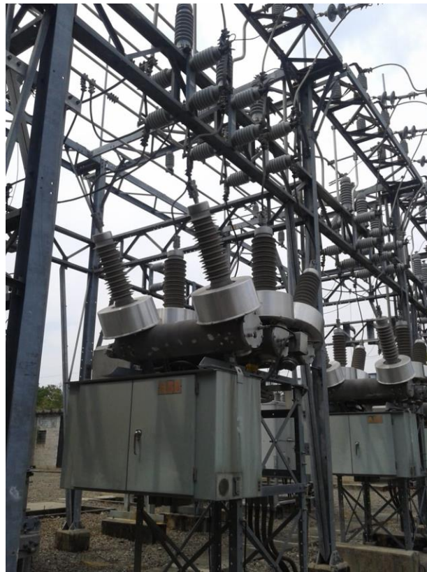
Interruptores de potencia aislados en gas SF6
