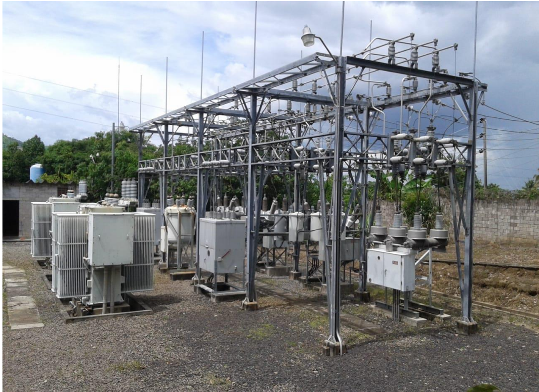
Subestación central ANDA
