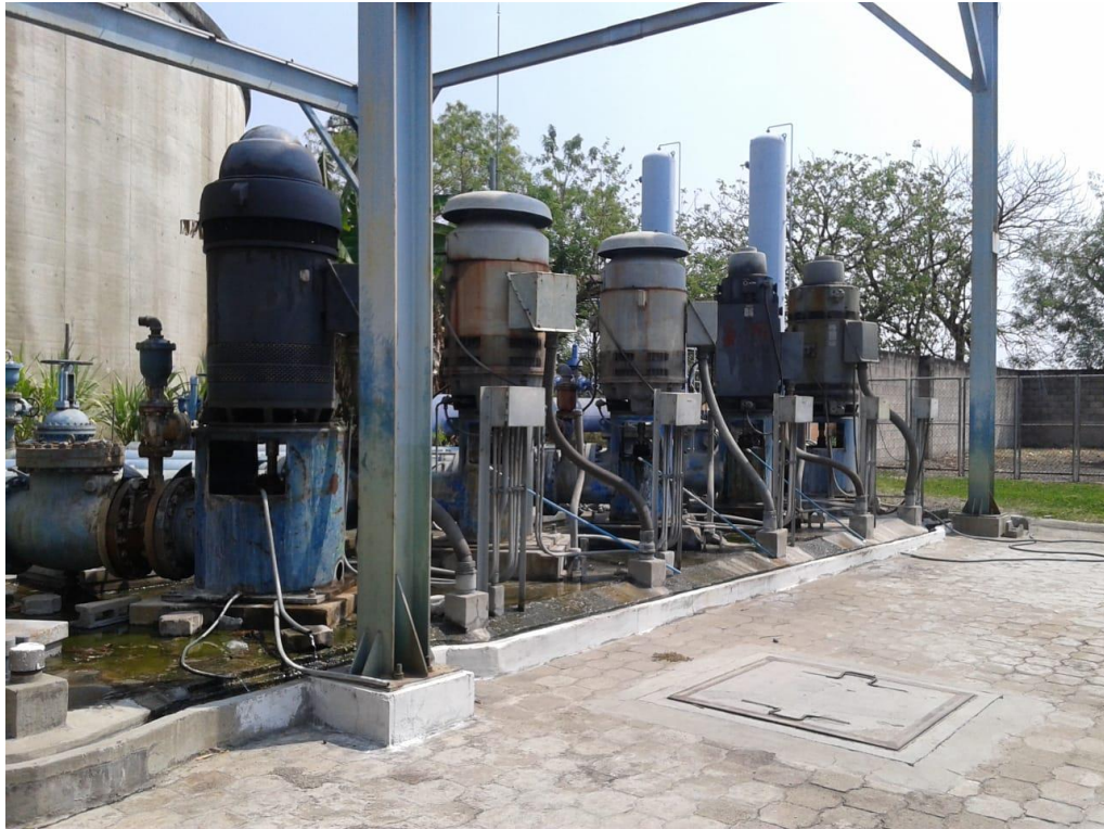
Subestación de bombeo San Ramon
