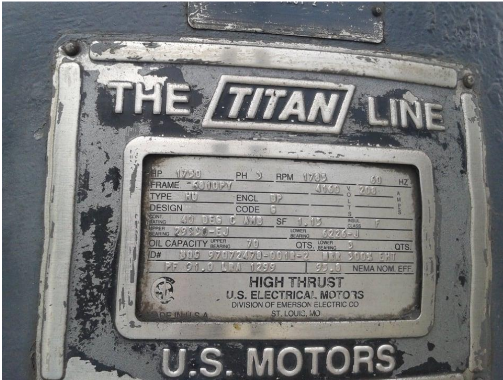
Figura 2.2 Placa de motor eléctrico de ANDA en bomba de 1750 hp
