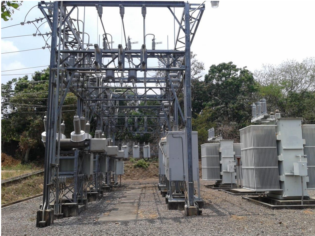
Subestación central ANDA
