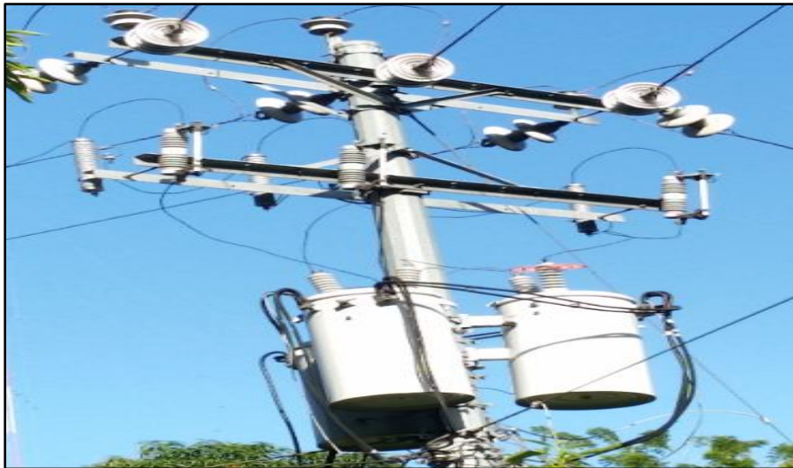
Figura 82. Banco trifásico para AA
