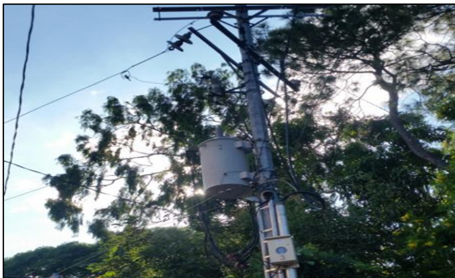
Figura 89. Transformador de 75 kVA monofásico para edificio Carlos Rodas.
