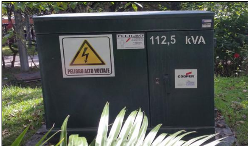
Figura 95. Transformador trifásico Pad-Mounted de 112.5 kVA para el edificio de jóvenes talentos
