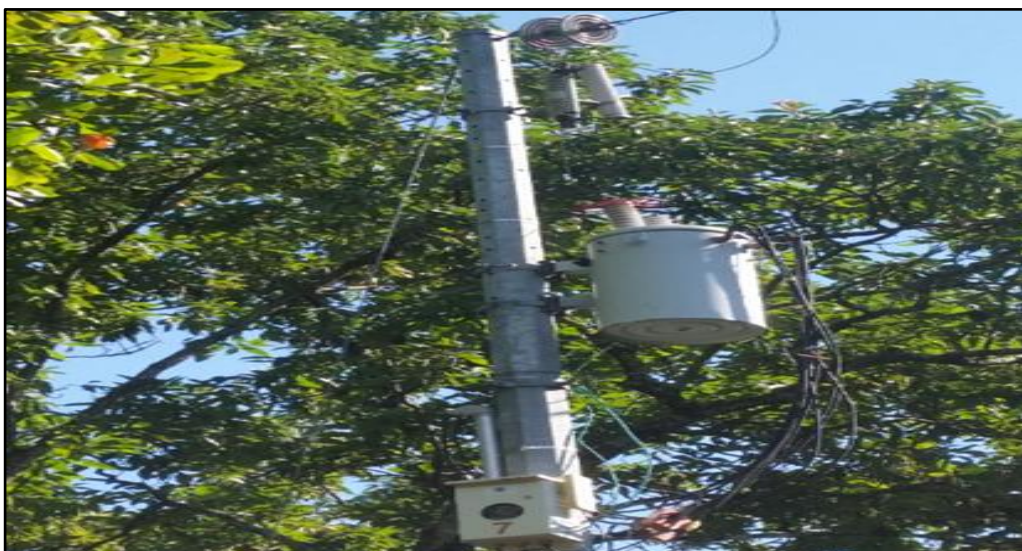
Figura 72. Transformador monofásico de 75 kVA, alimenta auditorium 4
