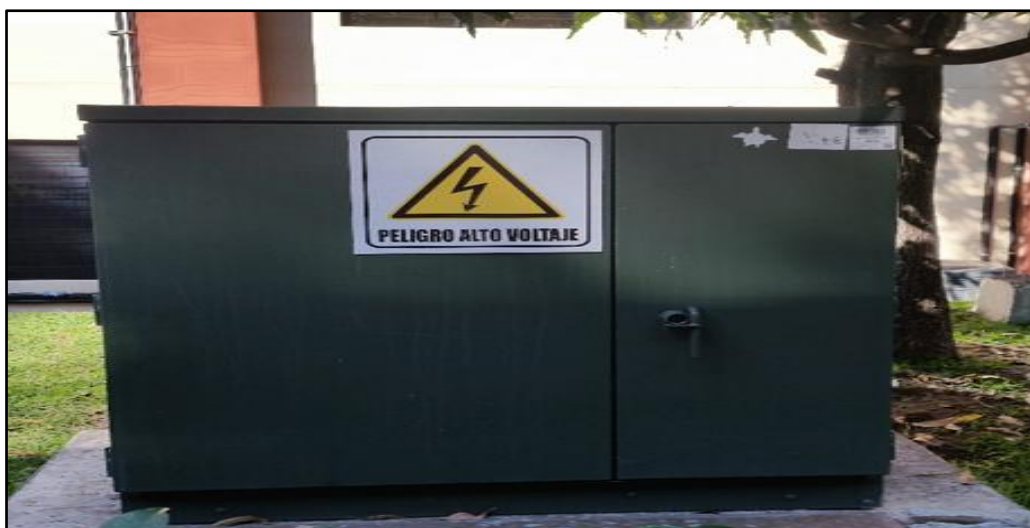
Figura76. Transformador pad-mounted trifásico de 150KVA edificio administrativo
