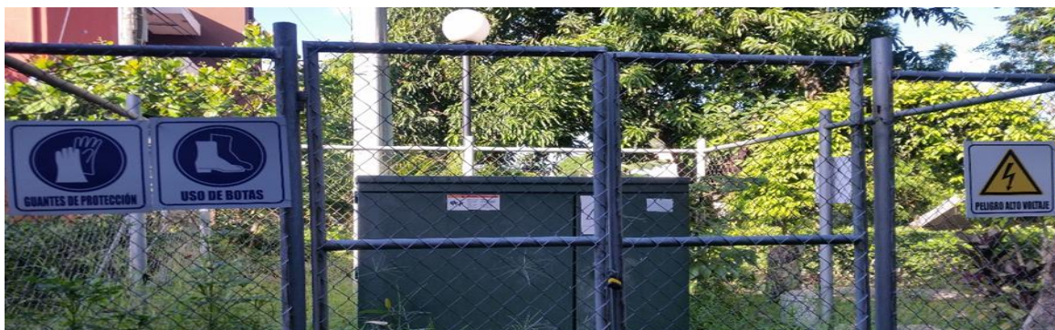
Figura 83. Transformador Pad-Mounted 225 kVA trifásico.
