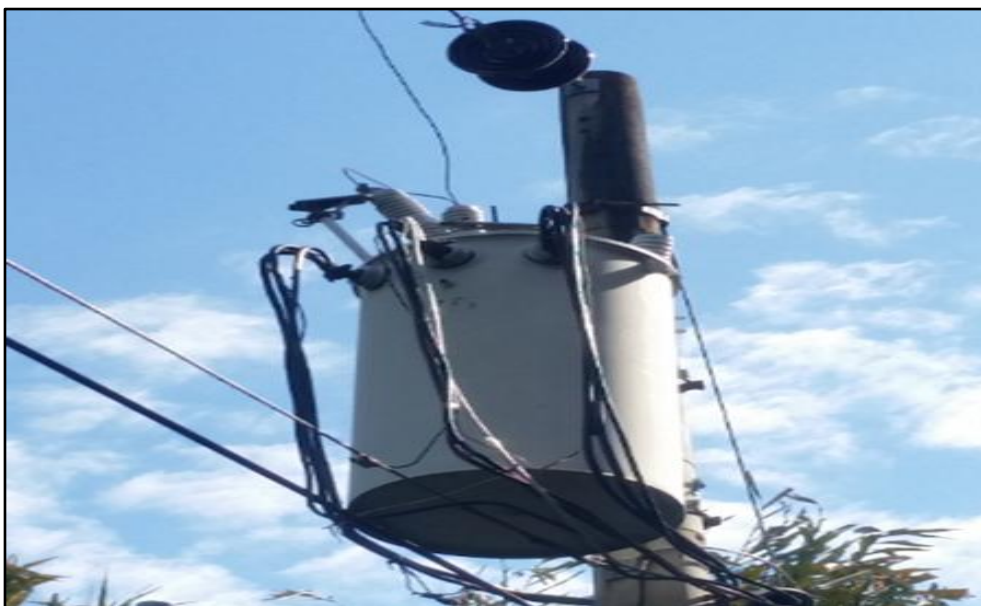
Figura 93. Transformador monofásico de 75 kVA, alimenta edificio de Química
