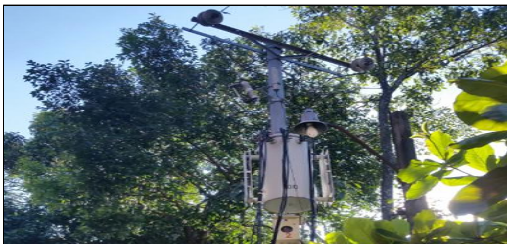
Figura 85. Transformador de 100 kVA monofásico para edificio Felipe Peña.
