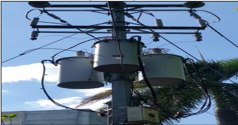
Figura 68. Arreglo trifásico de 150 KVA para alimentar edificio Periodismo
