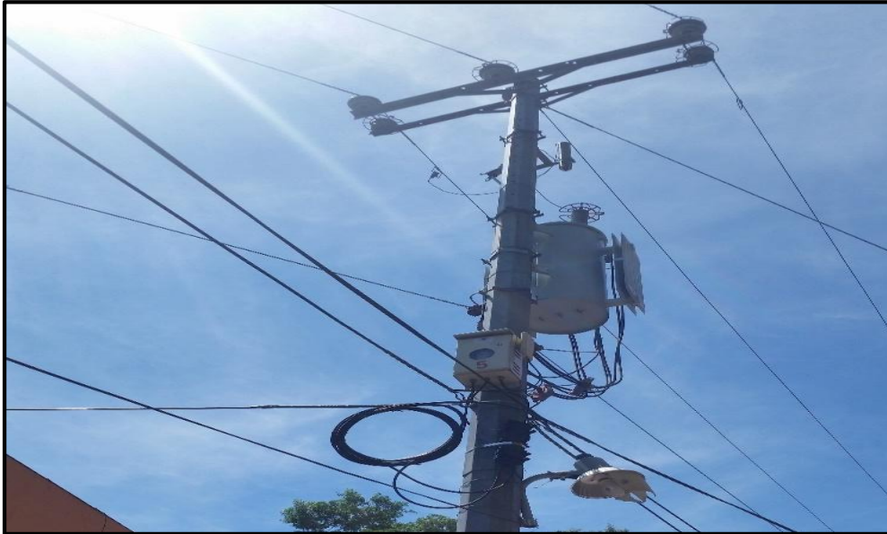
Figura 80. Transformador de 100 kVA que alimenta el edificio de Docentes
