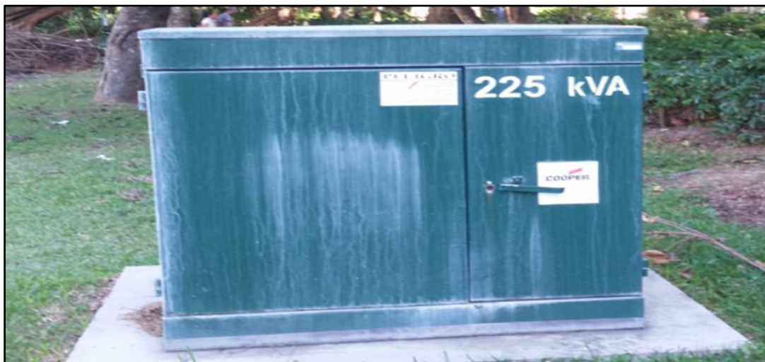
Figura 64. Transformador Pad-Mounted trifásico de 225 kVA de edificio de.
