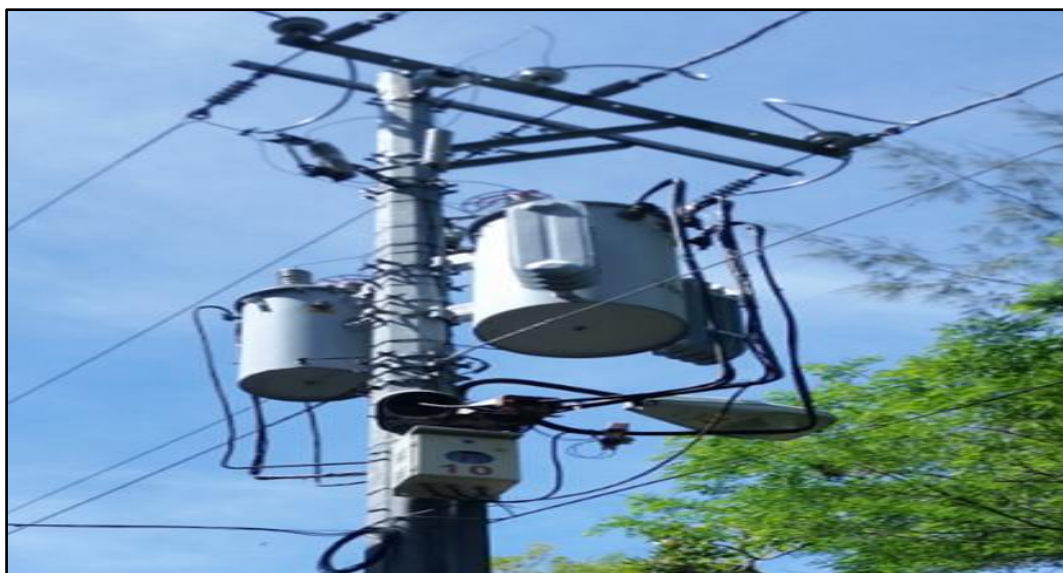
Figura 70. Transformadores monofásicos que alimenta el edificio de idiomas.
