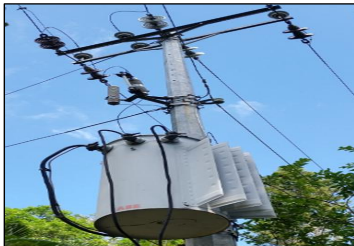
Figura 91. Transformador monofásico de 100 kVA para edificio de Biología.
