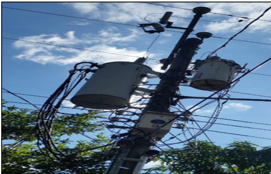
Figura 66. Transformador del edificio administrativo de Humanidades
