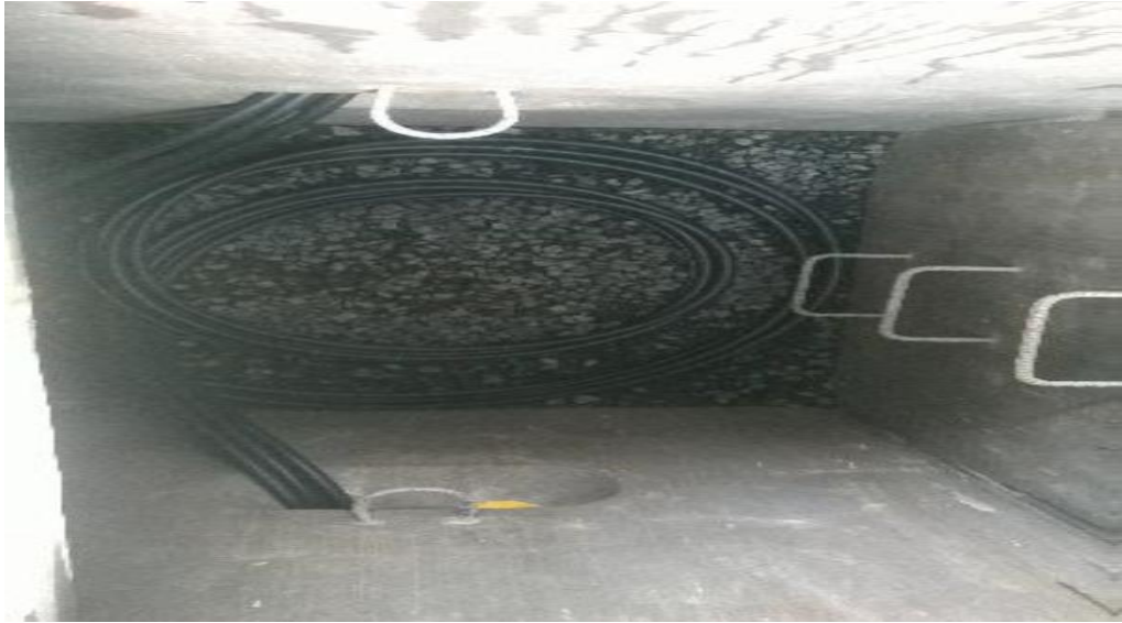
Figura 51. Pozo de paso para líneas primarias.
