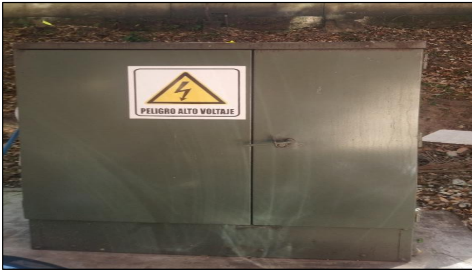
Figura 78. Transformador Pad-Mounted de 225 kVA para edificio Rafael Menjivar.
