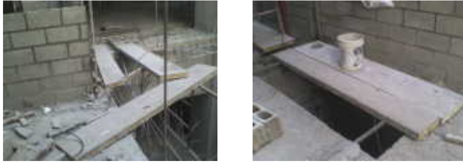
Fotografías 5.7 Rampas inadecuadas utilizadas en la construcción.
