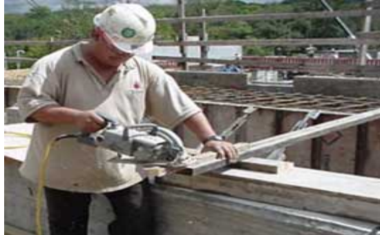
Fotografía 5.1 Trabajador sin su equipo completo de protección
