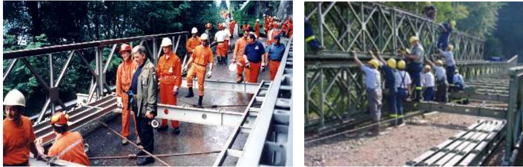
Figura 4.16 Vestuario para montaje de puentes metálicos modulares.
