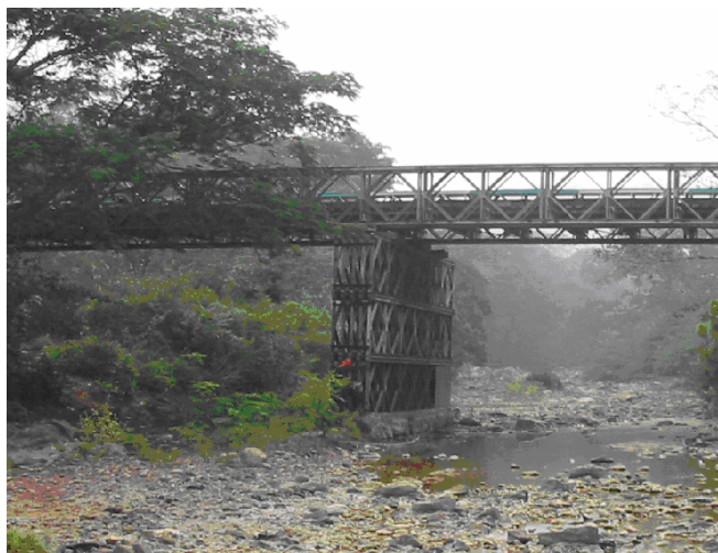
Figura 2.72 Pila Bailey Quintuple Triple bajo el puente Bailey TS-110' en el Km 177, San Sebastián, Ruta Militar, Santa Rosa de Lima, Depto. de La Unión.
