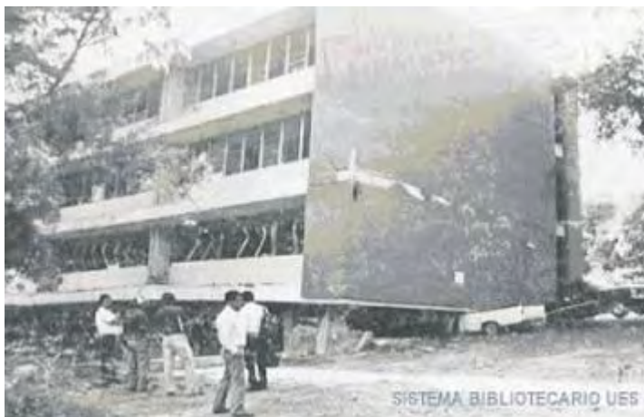
Los daños por el terremoto de 1986, dañaron severamente el campus universitario, dejando a la mayoría de edificios inhabilitados, y en estado de calamidad.
