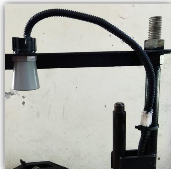
Figura 3 - 47 Sensor con cableado principal de estructura. Fuente: Elaboración Propia
