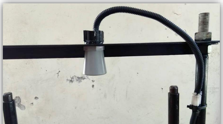
Figura 3 - 39 Colocación de sensor mediante una rosca. Fuente: Elaboración Propia
