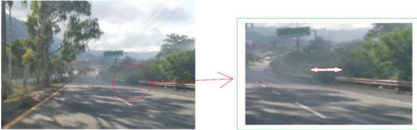
Figura 6.15 discontinuidad de barrera metálica
