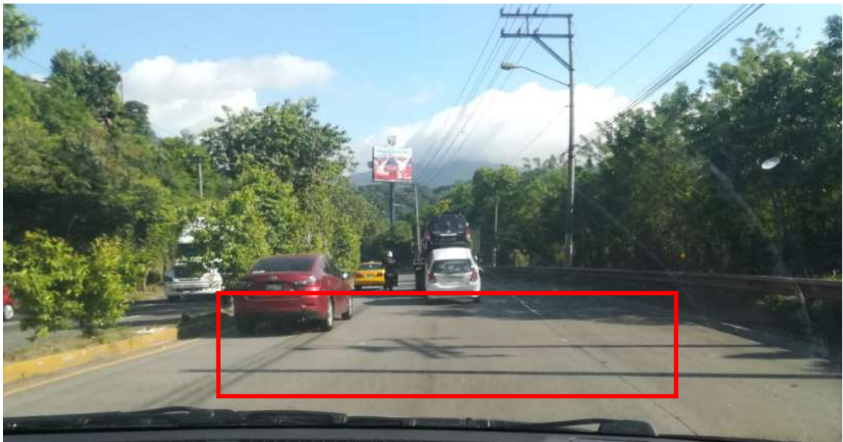
Figura 6.5 muestra una señalización horizontal deteriorada
