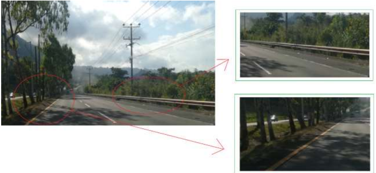
Figura 6.17 barrera metálica faltante
