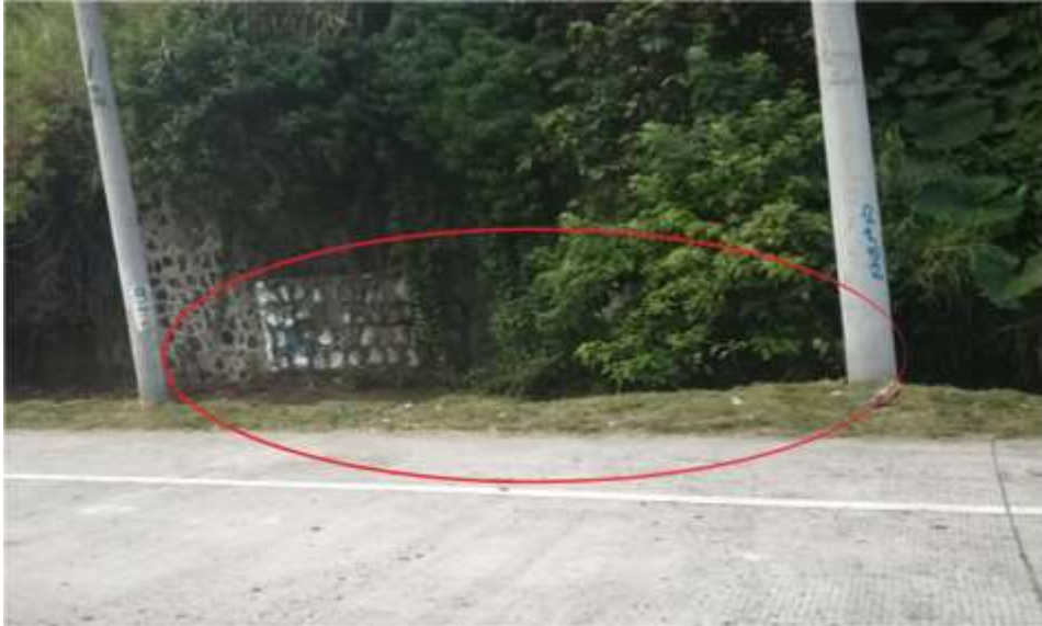
Figura 6.20 drenaje en malas condiciones
