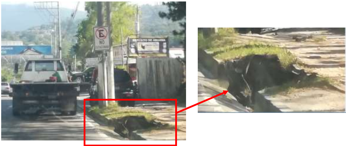
Figura 6.4 sistema de drenaje en malas condiciones
