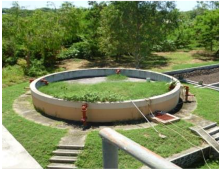
Figura 11. Digestor de lodos PTAR San Luis Talpa.
