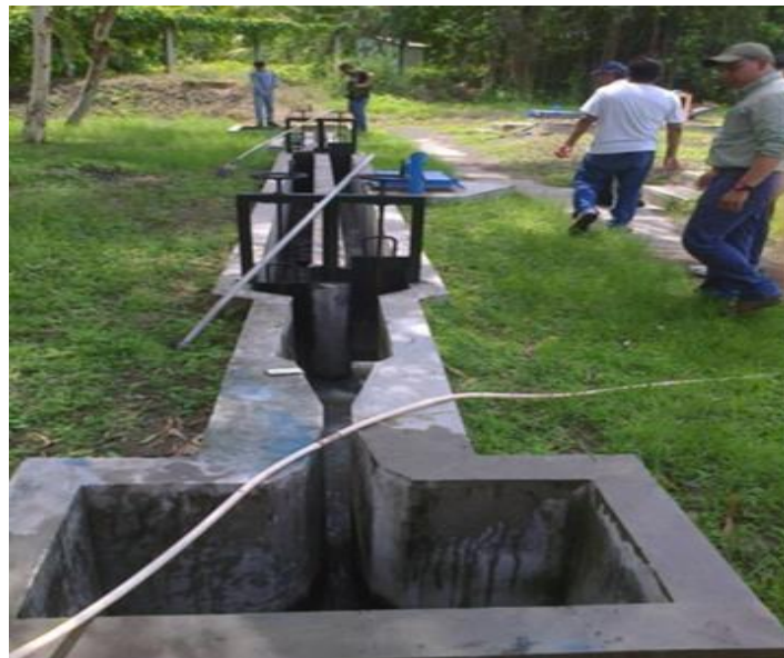
Figura 8. Desarenador en PTAR San Luis Talpa.
