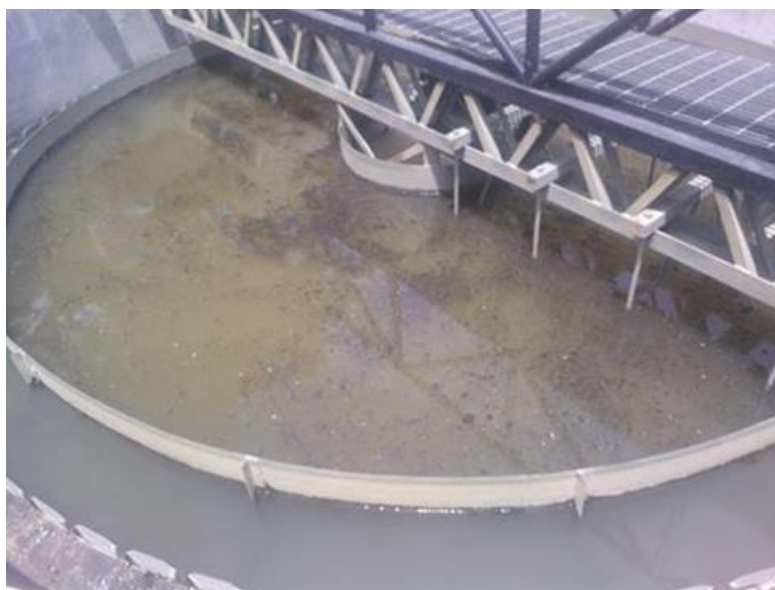
Figura 9. Sedimentador Primario de la PTAR San Luis Talpa.
