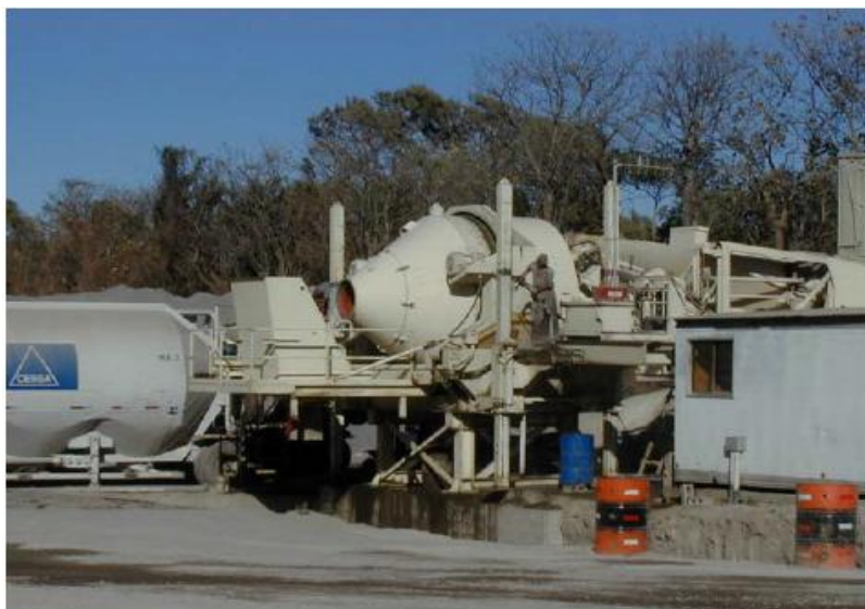
FIGURA N° 2.1: PLANTA DOSIFICADORA UTILIZADA PARA LA PRODUCCIÓN DE LA MEZCLA PARA CCR.
