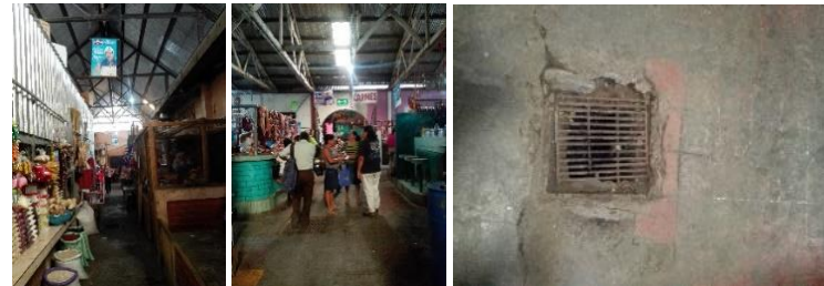
Imagen N° 42, 43 y 44: Drenajes en Pasillos del Mercado.
