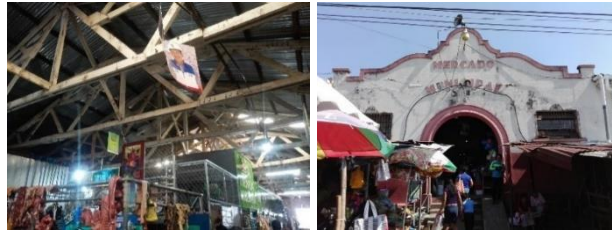
Imagen N°81 y 82: Infraestructura de Techos y Paredes Deterioradas.
