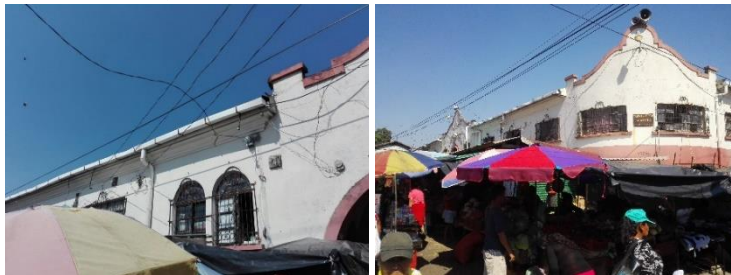
Imagen N°27 y 28: Ventanas Deterioradas Y Obstruidas.
