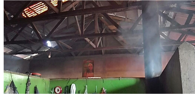
Imagen N°26: Contaminante por Humo en Zona de Cocinas.
