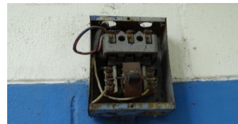
IMAGEN Nº 73: INSTALACIONES ELÉCTRICAS EXPUESTAS.
