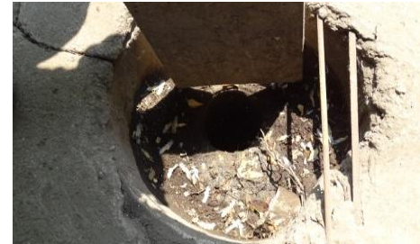
IMAGEN Nº 72: INSTALACIONES HIDRÁULICAS DE A.LL. EN MAL ESTADO.
