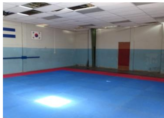
IMAGEN N° 106: CIELO FALSO DAÑADO EN ÁREA DE ENTRENAMIENTO.
