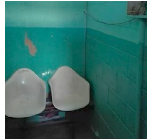
IMAGEN Nº 109: ESPACIO DE VESTIDORES INSUFICIENTE.
