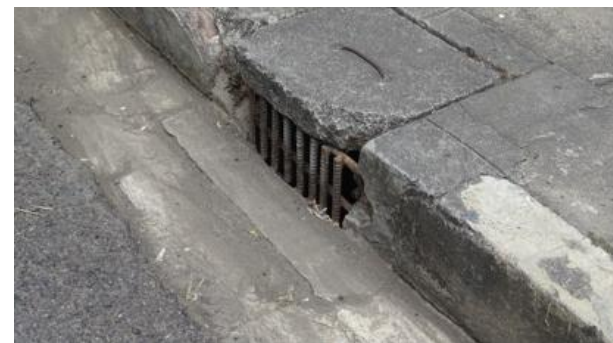
IMAGEN Nº 60: CUNETAS Y TRAGANTES DE AGUAS LLUVIAS.
