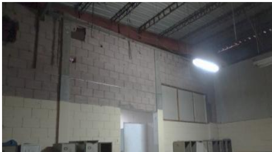
IMAGEN Nº 101: INSTALACIONES EN MAL ESTADO Y PROBLEMAS
