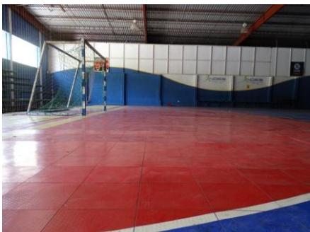
IMAGEN Nº 82: DUELA DAÑADA, ÚNICO PUNTO DE ENTRADA DE LUZ Y TECHO DAÑADO.
