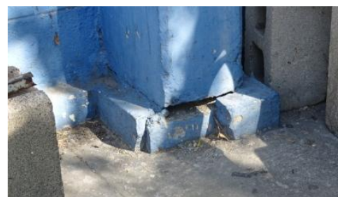
IMAGEN N° 112: LAS ESTRUCTURAS QUE SOPORTAN PAREDES TIENEN DAÑOS SIGNIFICATIVOS.
