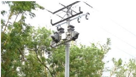
IMAGEN Nº 62: POSTE DE MEDIA TENSIÓN QUE SE DIRIGE A LA SUBESTACIÓN.
