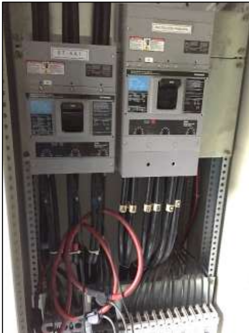
Figura 3.6-6 Conexión del analizador de redes en la protección principal de los equipos de aire acondicionado del primer nivel. Fuente: Propia
