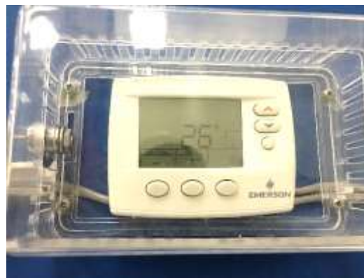
Figura 3.4-18 Termostato ubicado en el audiórium configurado a 26°C, sin rotulación, Fuente: Propia, 2018.
