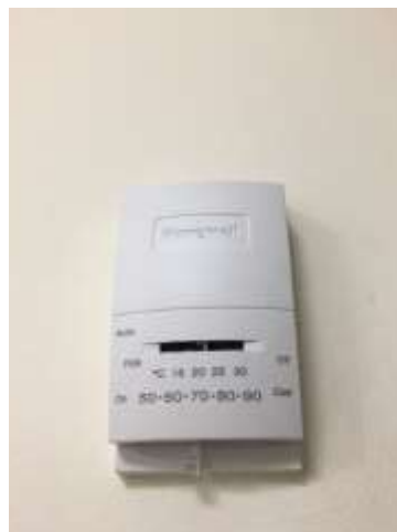
Figura 3.4-15 Termostato instalado en el segundo nivel del edificio, configurado a 22°C, sin protección ni señalización, Fuente: Propia, 2018
