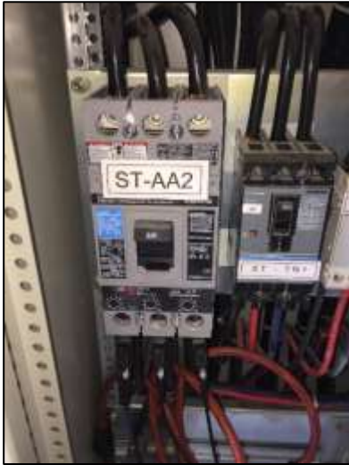
Figura 3.6-4 Conexión del analizador de redes en la protección principal de los equipos de aire acondicionado del segundo nivel. Fuente: Propia
