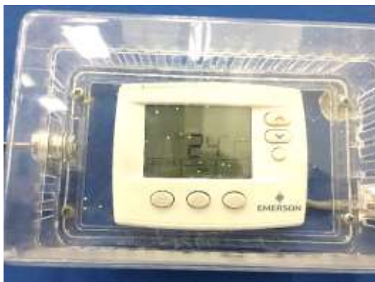
Figura 3.4-17 Termostato ubicado en audiórium configurado a 24°C, sin rotulación, Fuente: Propia, 2018.
