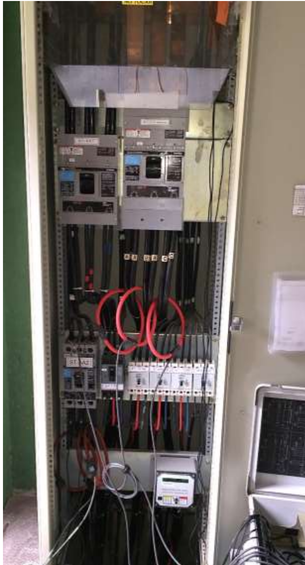
Figura A 5 Tablero eléctrico general del edificio de postgrado. Fuente. Propia
