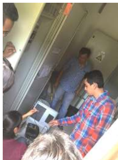
Figura 3.4-6 Conexión del analizador de redes sobre la protección principal del edificio, con la ayuda de la escuela de Ingeniería Eléctrica, Fuente: propia, mayo 2018
