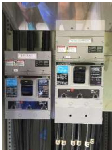
Figura 3.4-5 Protección principal del edificio de postgrados, al cual se conectó el analizador de redes. Fuente: propia. Mayo 2018
