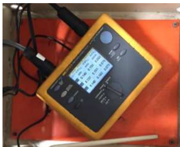
Figura A 4 Analizador de Redes Fluke 1735. Fuente: Propia
