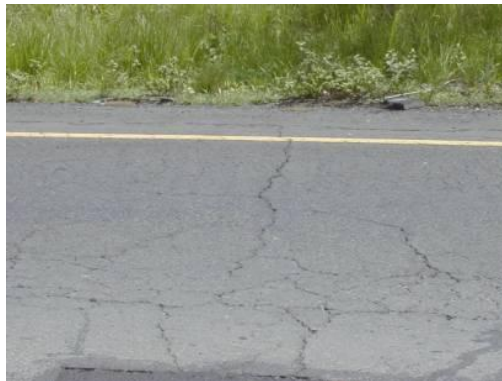
Figura 2.32 Fisuras En Bloque
