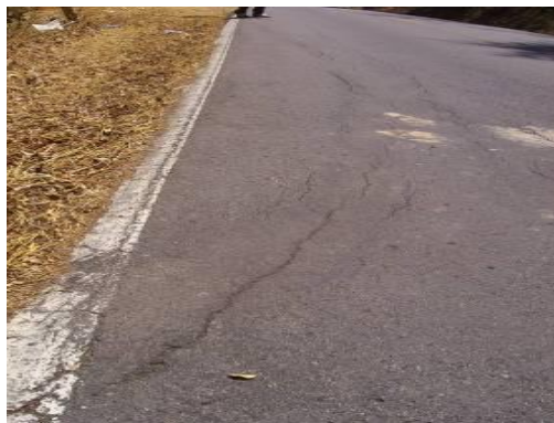
Figura 2.33 Fisuras En Arco
