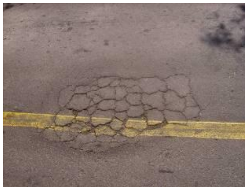
Figura 2.31 Fisuras Piel de Cocodrilo
