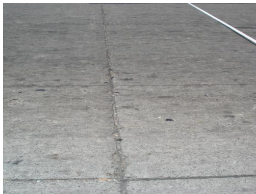
Figura 2.27 Deficiencias en Material de Sello
