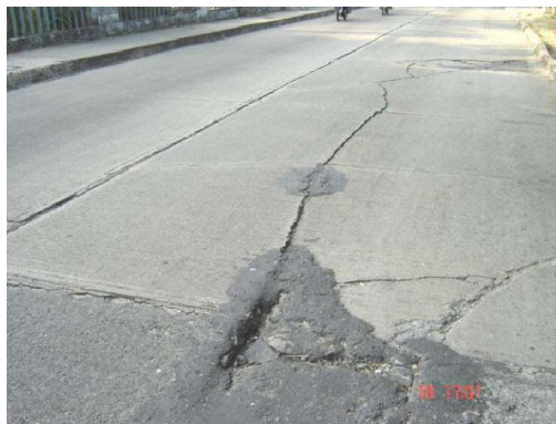
Figura 2.18 Fisuras en Bloque
