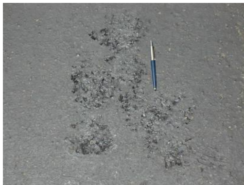
Figura 2.45 Exudación de Asfalto
