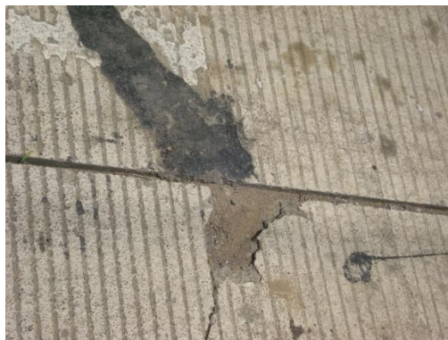
Figura 2.25 Descascaramiento y Fisuras capilares
