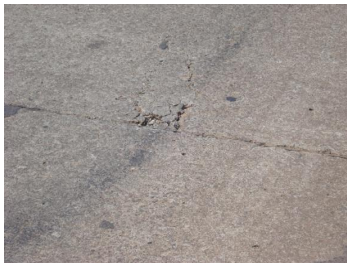
Figura 2.29 Fisuras por Mal Funcionamiento de Juntas
