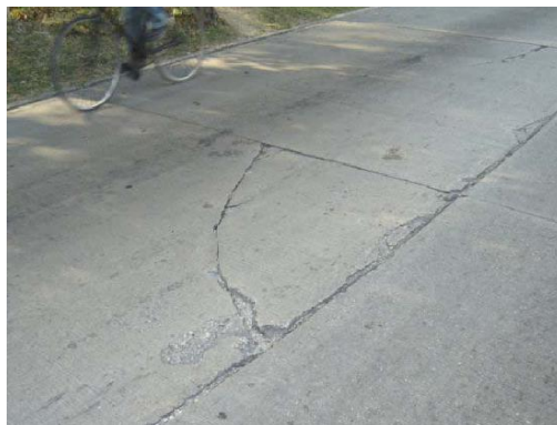
Figura 2.16 Fisura de Esquina
