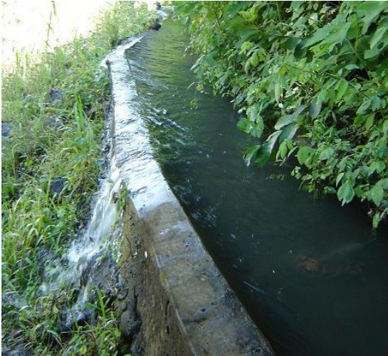
Revalse del del agua en canal de conducción.
