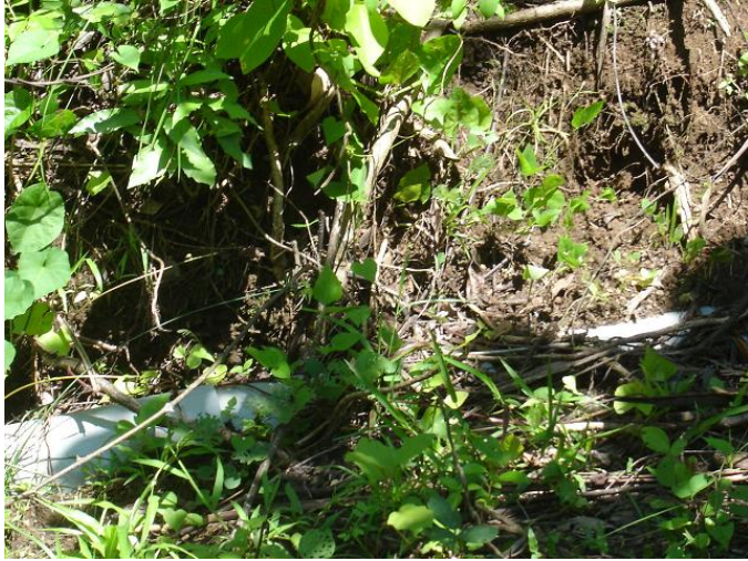
Tubería Forzada Tubería Forzada, PVC 10" a 160 psi, tramo superficial, el resto está enterrada y anclada.
