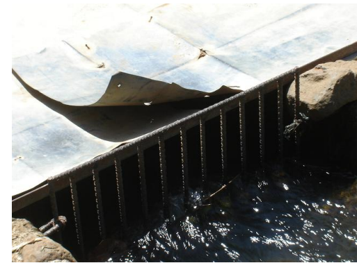
Rejilla de entrada a Cámara Revalse de Carga.
