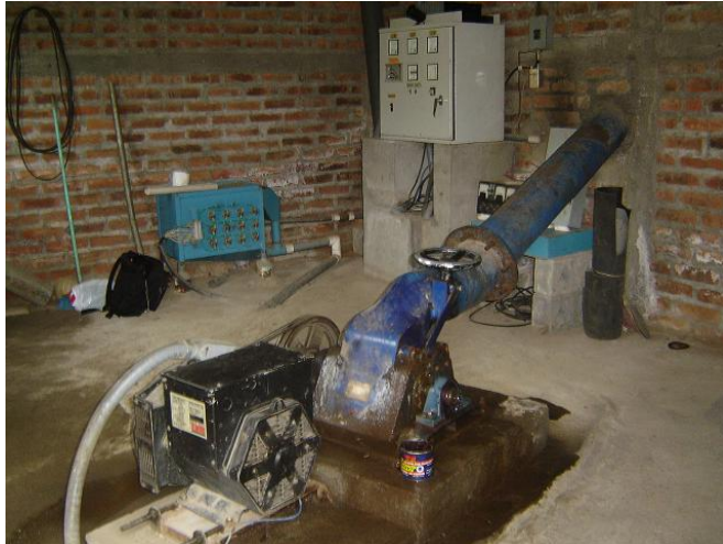
Llegada de Tubería Forzada, Válvula de control, Turbi Michell Banki, Generador Eléctrico y Panel de Control Eléctrico.
