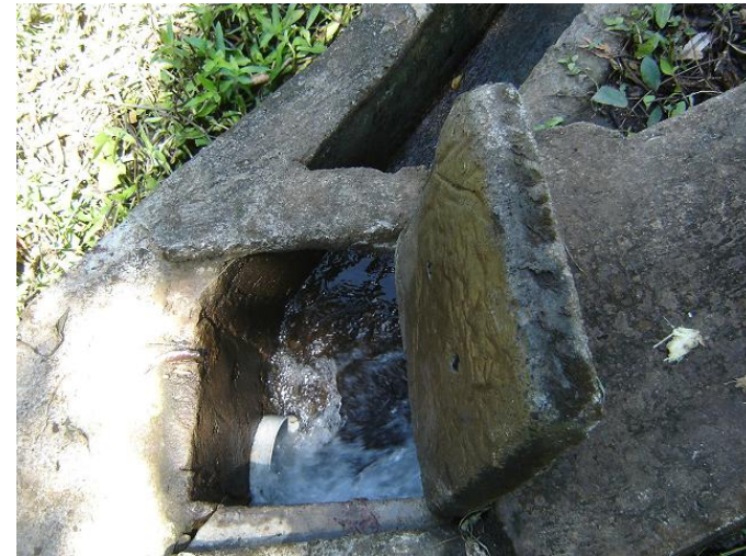
Entrada de agua a tubería Forzada.
