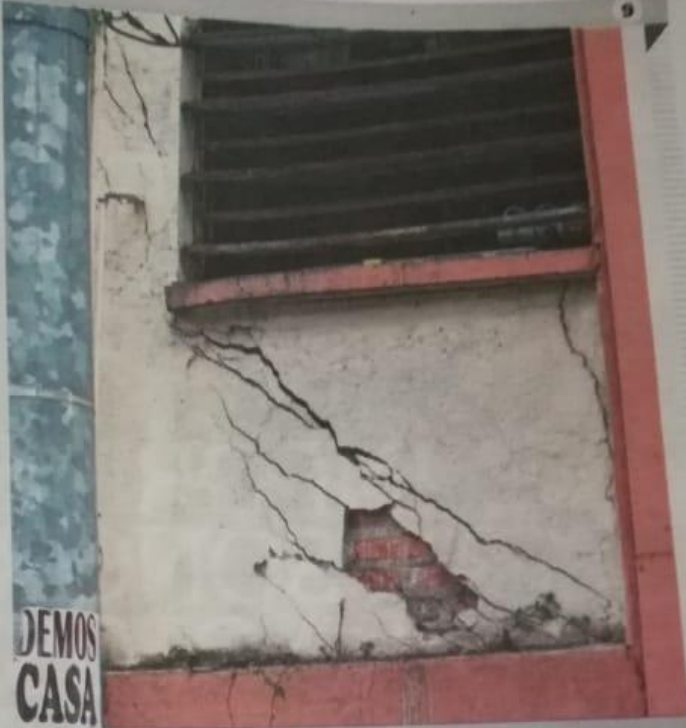
Inhabitables. Dos edificios de colonia Málaga fueron declarados inhabitables después de los terremotos de 1986. Sin embargo, todavía hay personas que viven en sus apartamentos.
