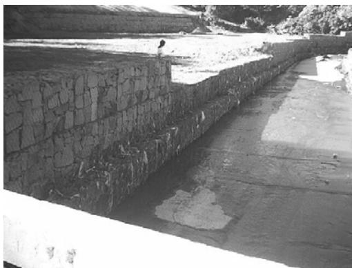
Figura 2.25 Muros Gaviones en Puente El Garrobo, Colonia Costa Rica, San Salvador, El Salvador
