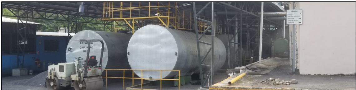
Ilustración 3.2 – Tanques de almacenamiento ASFALCA S.A. de C.V.
