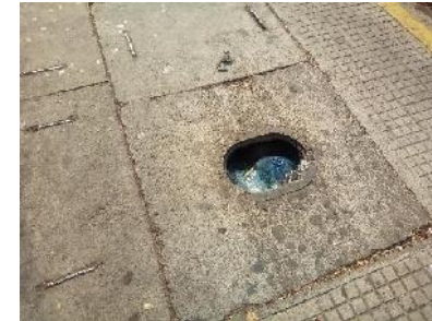
Fotografía 72: Contador sin tapadera sobre 1° Calle Poniente.
