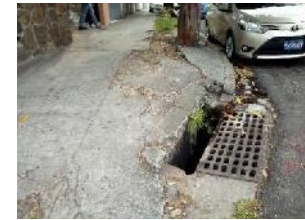
Foto 55: Tragante en mal estado sobre 25 Calle Poniente Colonia Médica.
