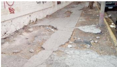
Fotografía 75: Acera sobre 1° Calle Poniente Hospital Rosales.
