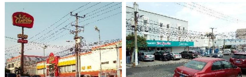
Fotografía 46: Cableado eléctrico y telefonía sobre 25 Av. Norte (izquierda) y 23 Av. Norte costado poniente de ex Embajada Americana
