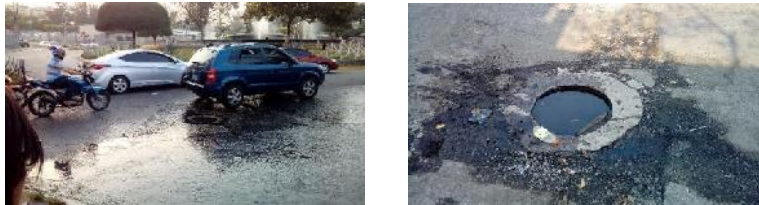
Fotografía 57, 58: Izquierda: Pozo de aguas lluvias sin tapadera y obstruido provocando la formación de charcos sobre fuente luminosa. Derecha: pozo de aguas negras sin tapadera causando mal olor sobre 23 Av. Norte
