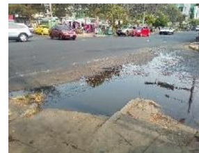
Foto 54: Inundación por tragante obstruido sobre 25 Av. Norte frente Shopping Center.
