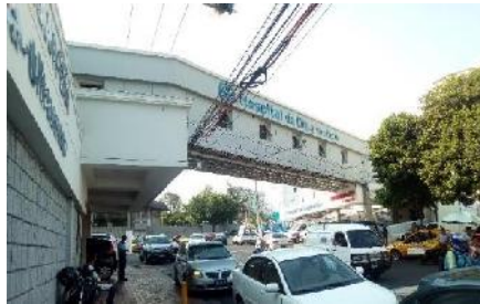
Fotografía 45: Cableado de telefonía debajo de pasarela del Hospital de Diagnóstico.
