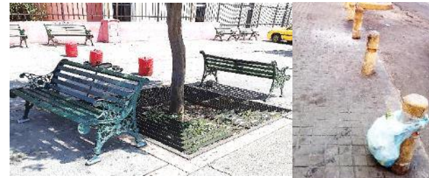
Fotografía 65: Bancas, alcorques y bolardos en mal estado.
