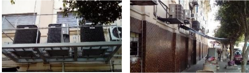
Fotografía 47: Condensadores de aire acondicionado en fachada del Hospital 1° de mayo
