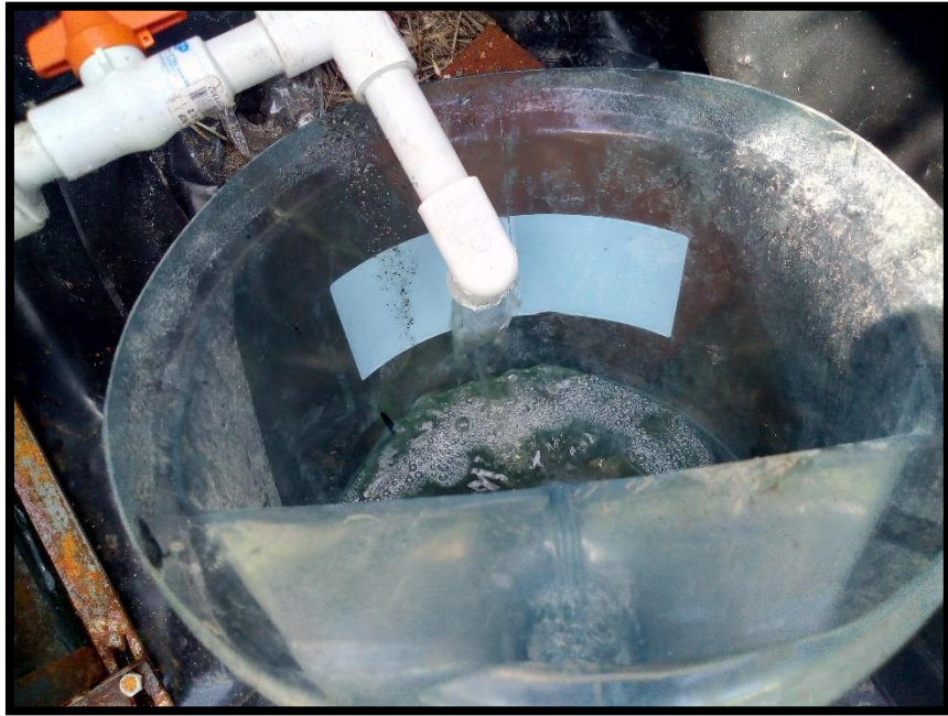
Figura 11.9 Caudal de salida del agua tratada del humedal artificial.
