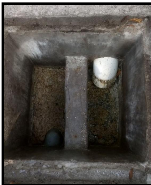
Figura 1.2 Sistema de trampa de grasas del comedor n°3 de la Universidad de El Salvador.
